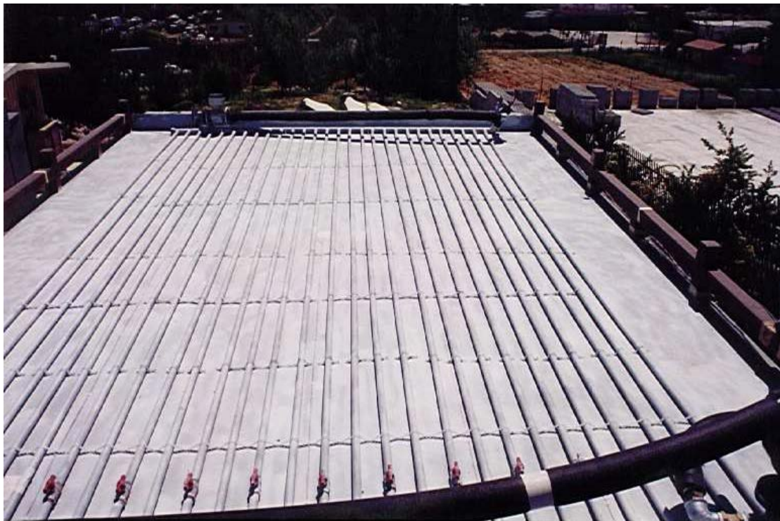
Εικόνα 1.4.2 Οροφή με Ακτινοβολητή Νερού[1].
