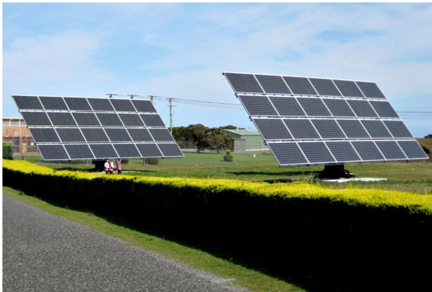
Εικόνα 3.13. Διατάξεις ιχνηλάτησης της πορείας του ήλιου διπλού άξονα (Πηγή: www.google.gr )
