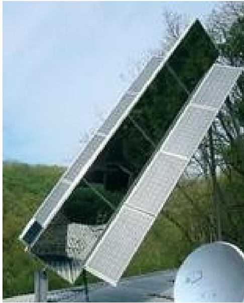
Εικόνα 3.10. Ηλιακό κάτοπτρο σε φωτοβολταϊκό πάρκο (Πηγή: www.greenenergia.gr )
