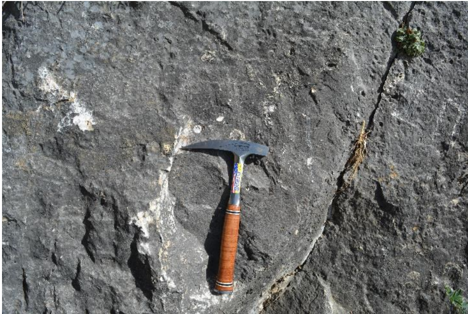
Φωτογραφία 5-3: Ασυνέχεια στο δεξί πρανές
