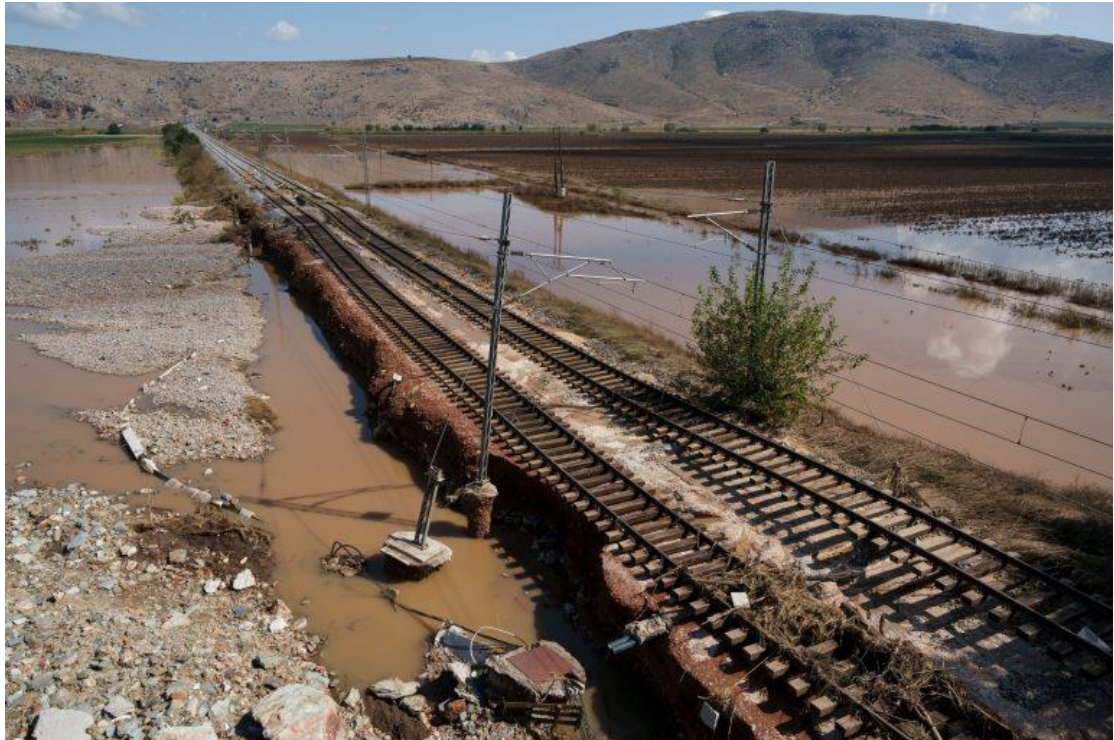
Εικόνα 1.2:Υποχώρηση της υποδομής του σιδηροδρομικού επιχώματος λόγω ροής νερού εξαιτίας της κακοκαιρίας Daniel το 2023
