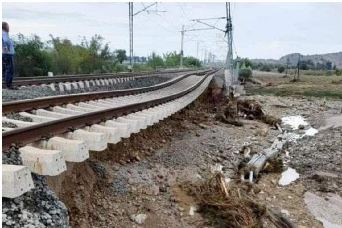
Εικόνα 1.1: Καταστροφή σιδηροδρομικού επιχώματος από την κακοκαιρία Daniel στη Θεσσαλία το 2023
