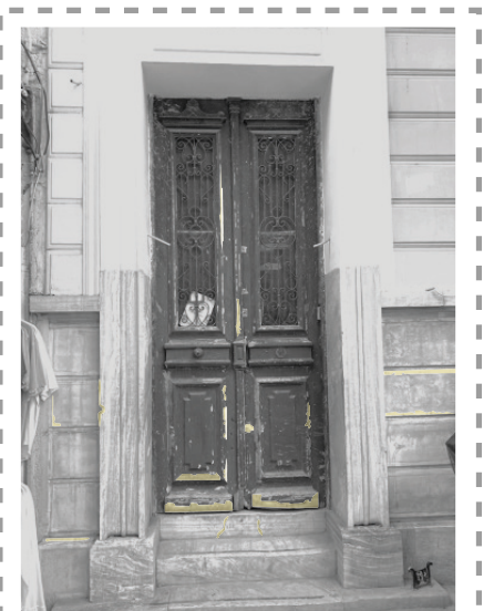
Έλλειψη συντήρησης, εγκατάλειψη διατηρητέων
