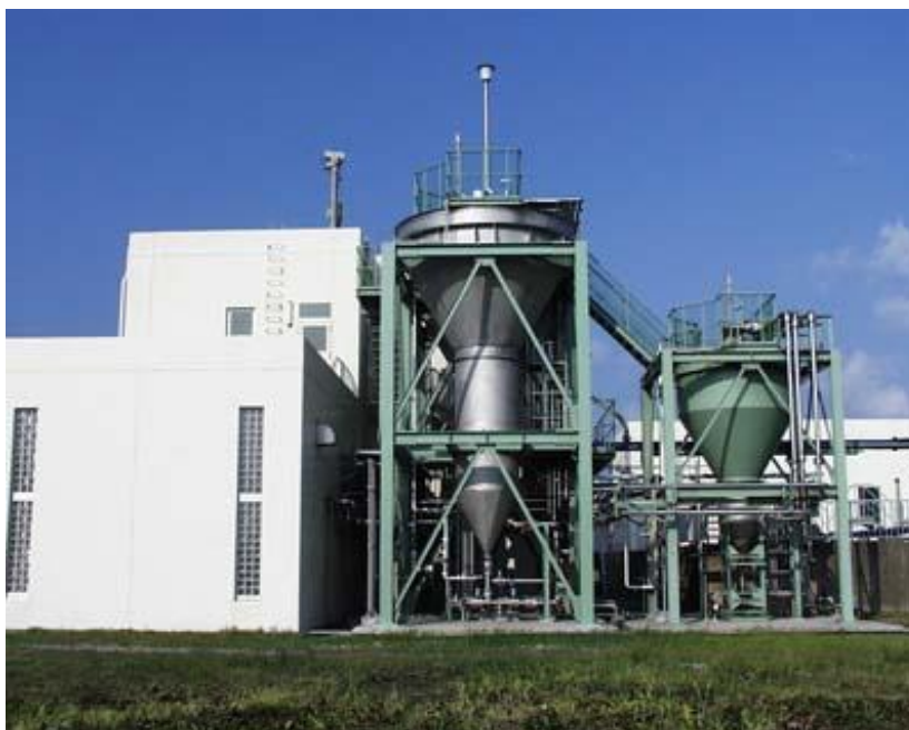
Σχήμα 4.23 – Η εγκατάσταση που λειτουργεί με την μέθοδο Phosnix στην λίμνη Shinji Eastern Clarification Center of Shimane Prefecture (SECC) στην Ιαπωνία (Nawa 2009)
