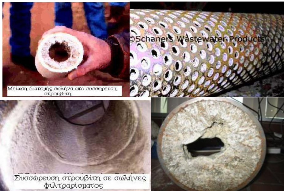
Σχήμα 3.4 – Τυπικά προβλήματα σωληνώσεων λόγω εμφάνισης στρουβίτη
