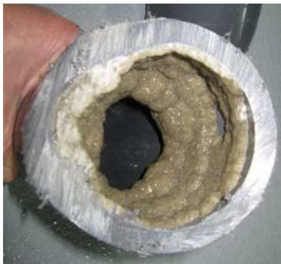
Σχήμα 4.21 – Σχηματισμός επικαθίσεων στρουβίτη εντός των σωληνώσεων της εγκατάστασης
