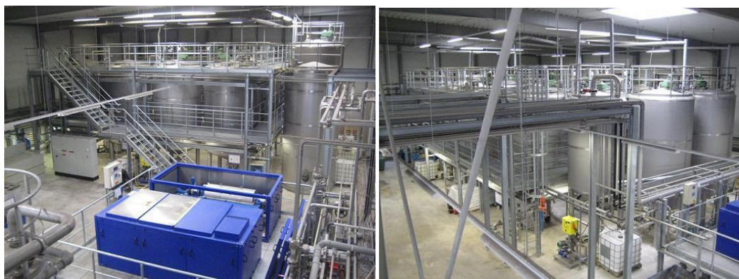
Σχήμα 4.25 – Εσωτερικό της μονάδας ανάκτησης φωσφόρου στο Gifhorn της Γερμανίας (Seaborne brochure, Hermann, BAFU 2009)
