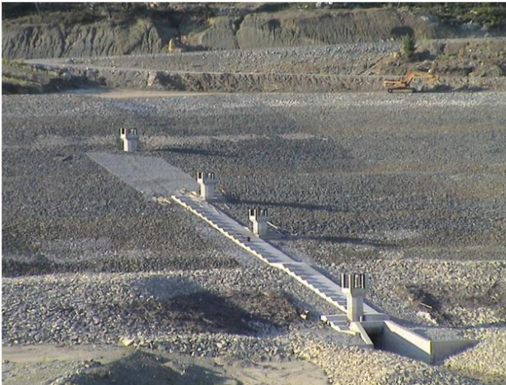
Σχήμα 2.10: Στόμια υδροληψίας - εκκένωσης (πηγή: ΑΕΓΕΚ, 2005)
