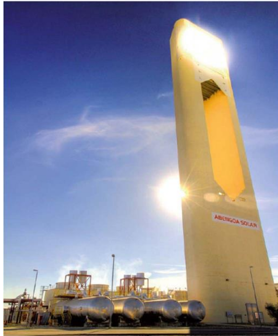
Εικόνα 5: Συσσωρευτές ατμού του σταθμού PS10 στη νότια Ισπανία, της εταιρείας Abengoa [148].
