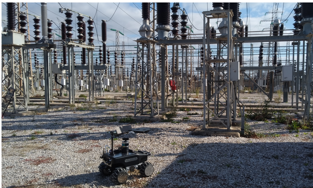
Figure 1. Το ρομπότ που έχουμε στη διάθεσή μας στο εξωτερικό περιβάλλον του Κέντρου Υψηλής Τάσης (ΚΥΤ) της Παλλήνης. Φαίνονται πίσω και μερικά πιθανά στοιχεία προς επιθεώρηση, πάνω στους αντίστοιχους στήλους.
