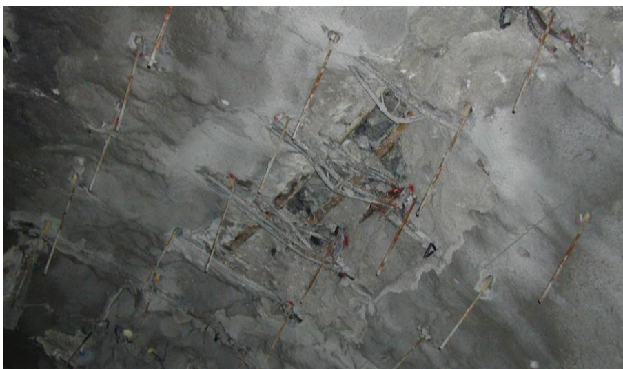
Εικόνα 6.6 Αστοχία των πλαισίων Lattice Girder στη σήραγγα Ανθοχωρίου λόγω υπερφόρτισης του κελύφους της υποστήριξης (Πηγή: ΤΙΑΣ, Μαρίνος et al., 2006; Μαρίνος Β., 2007; Μαρίνος et al., 2010).
