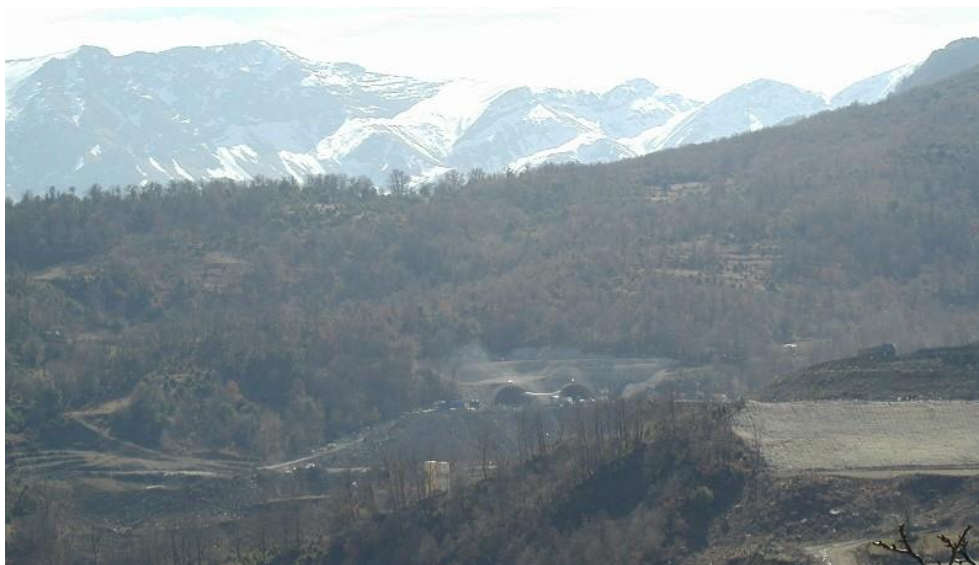
Εικόνα 6.4 Άποψη της εισόδου της σήραγγας Ανθοχωρίου κατά τη φάση της εκσκαφής και άμεσης υποστήριξης (Πηγή: ΤΙΑΣ, Μαρίνος et al., 2006; Μαρίνος Β., 2007; Μαρίνος et al., 2010).
