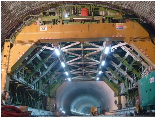
Εικόνα 3.1 Τελική επένδυση από ωπλισμένο σκυρόδεμα (Σήραγγα Τ2, Παράκαμψη Τεμπών).
