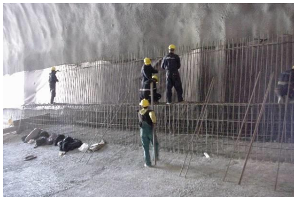
Εικόνα 3.6 Τοποθέτηση οπλισμού τελικής επένδυσης. Διακρίνεται το ήδη σκυροδετημένο ανάστροφο τόξο (Σήραγγα Σ13, Πηγή: ΤΙΑΣ, Μαρίνος Β., 2007).
