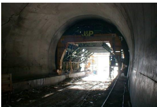
Εικόνα 3.9 Μεταλλότυπος για τη σκυροδέτηση τελικής επένδυσης, «χελώνα» (Σήραγγα Σ12, Πηγή: ΤΙΑΣ, Μαρίνος Β., 2007).
