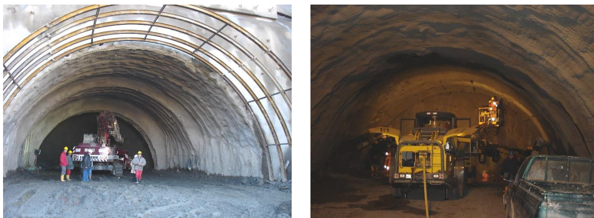
Εικόνα 4.1 Χαρακτηριστικές φωτογραφίες από την άμεση υποστήριξη σηράγγων στις οποίες διακρίνεται η μακροσκοπική κυμάτωση, η οποία διακρίνεται στην εσωτερική επιφάνεια του εκτοξευόμενου σκυροδέματος. Αποτέλεσμα της κυμάτωσης αυτής είναι η αύξηση της δυσμησίας και της διατμητικής αντοχής στη διεπιφάνεια γεωυλικού - εκτοξευόμενου σκυροδέματος και εκτοξευόμενου σκυροδέματος - τελικής επένδυσης.
