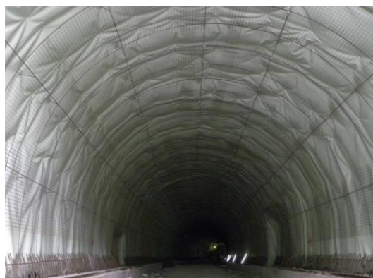
Εικόνα 3.12 Άποψη σήραγγας με άοπλη τελική επένδυση. Το μεταλλικό πλέγμα τοποθετείται έναντι ρωγμάτων και συστολής ξήρανσης, ενώ τα πέδιλα είναι οπλισμένα (Σήραγγα Νεοχωρίου).
