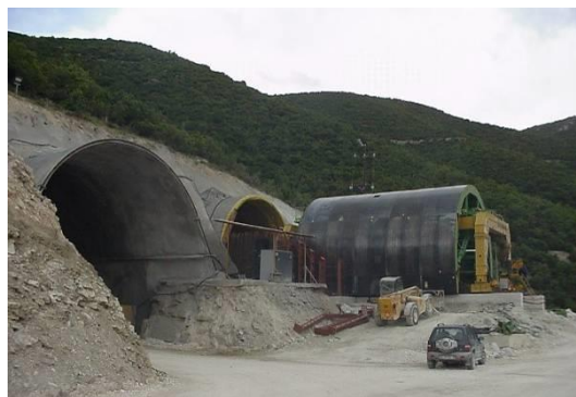
Εικόνα 3.10 Μεταλλότυπος για τη σκυροδέτηση τελικής επένδυσης, «χελώνα» (Σήραγγα Σ13, Πηγή: ΤΙΑΣ, Μαρίνος Β., 2007).
