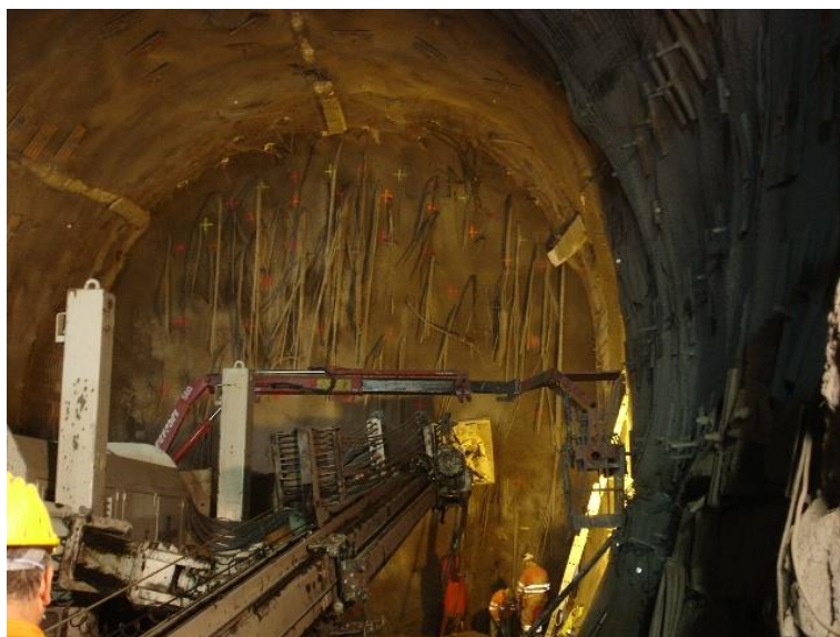
Εικόνα 5.3 Μέτωπο διάνοιξης της σήραγγας πρόσβασης Saint Martin La Porte στη σήραγγα βάσης Lyon - Turin.
