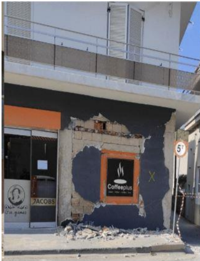
Εικόνα 6: Εκτός επιπέδου αστοχία τοιχοποιίας λόγω λυγισμού στον σεισμό της Σάμου [13]
