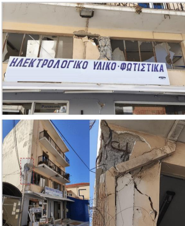
Εικόνα 2: Αστοχία κτηρίου με ανοίγματα στη μια διεύθυνση προς την οδό για εμπορική χρήση [13]
