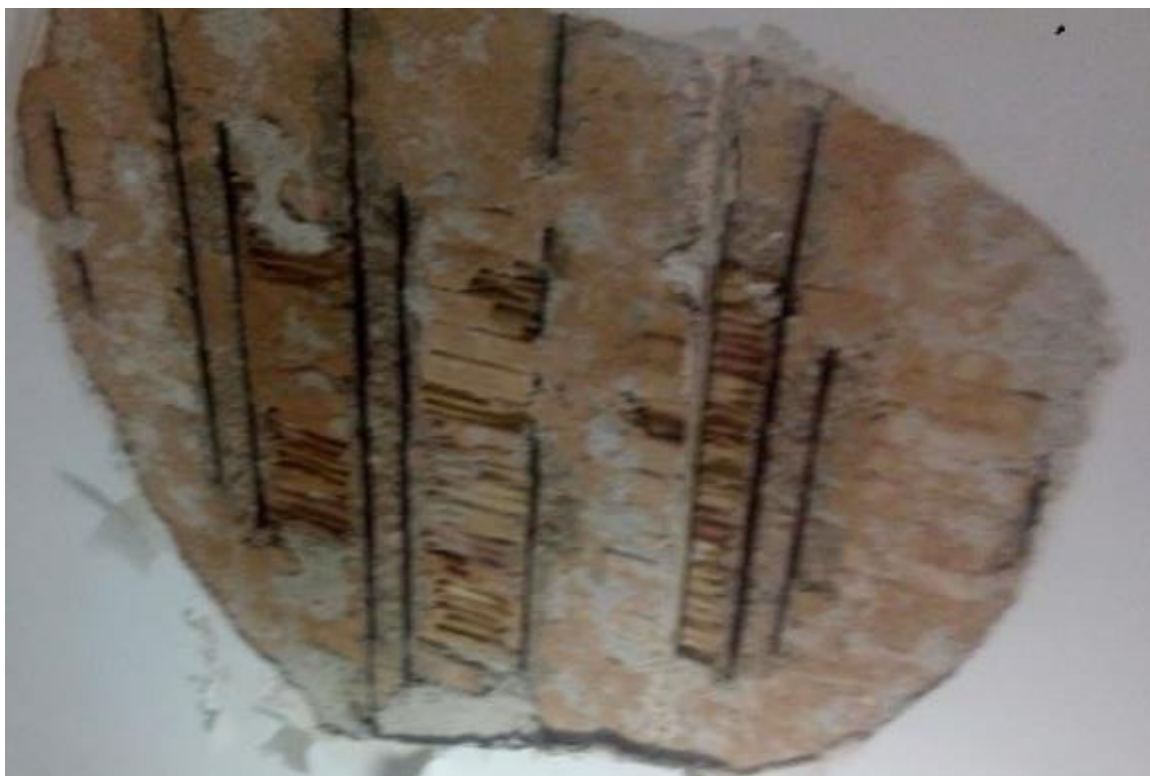
Εικόνα 1: Πλάκα με διαδοκίδες οπλισμένου σκυροδέματος και πλήρωση με οπτόπλινθους αμφίβολης διαφραγματικής λειτουργίας
