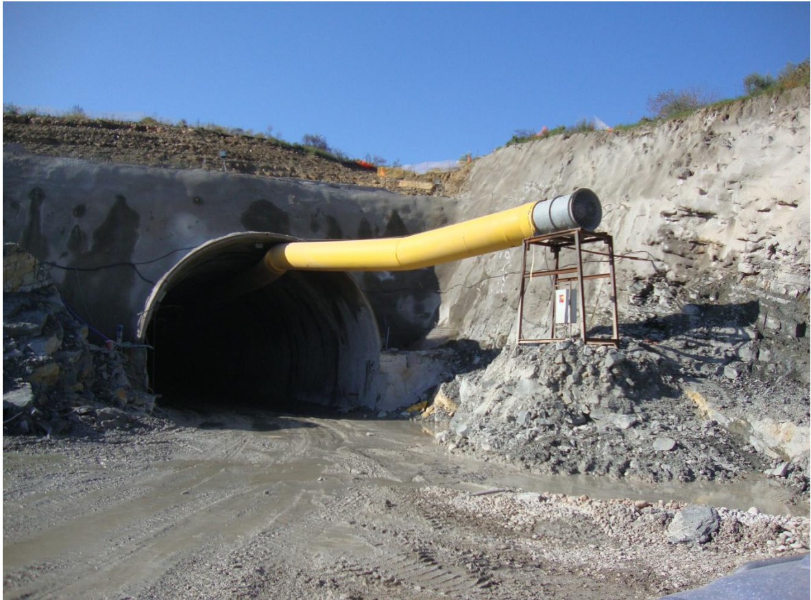
Εικόνα 6.10: Σύστημα αερισμού της σήραγγας (δεξιός κλάδος)
