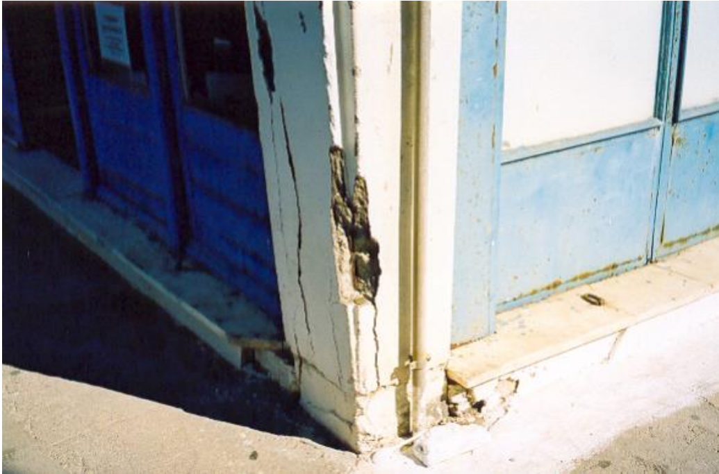
Σχήμα 3.2. Μέλος σκυροδέματος ύστερα από διάβρωση λόγω διείσδυσης χλωριόντων.
