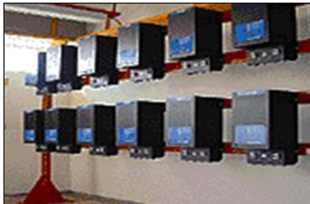
Σχήμα 4.6: Διάταξη ΦΒ αντιστροφέων TAURO στο χώρο εγκατάστασης
