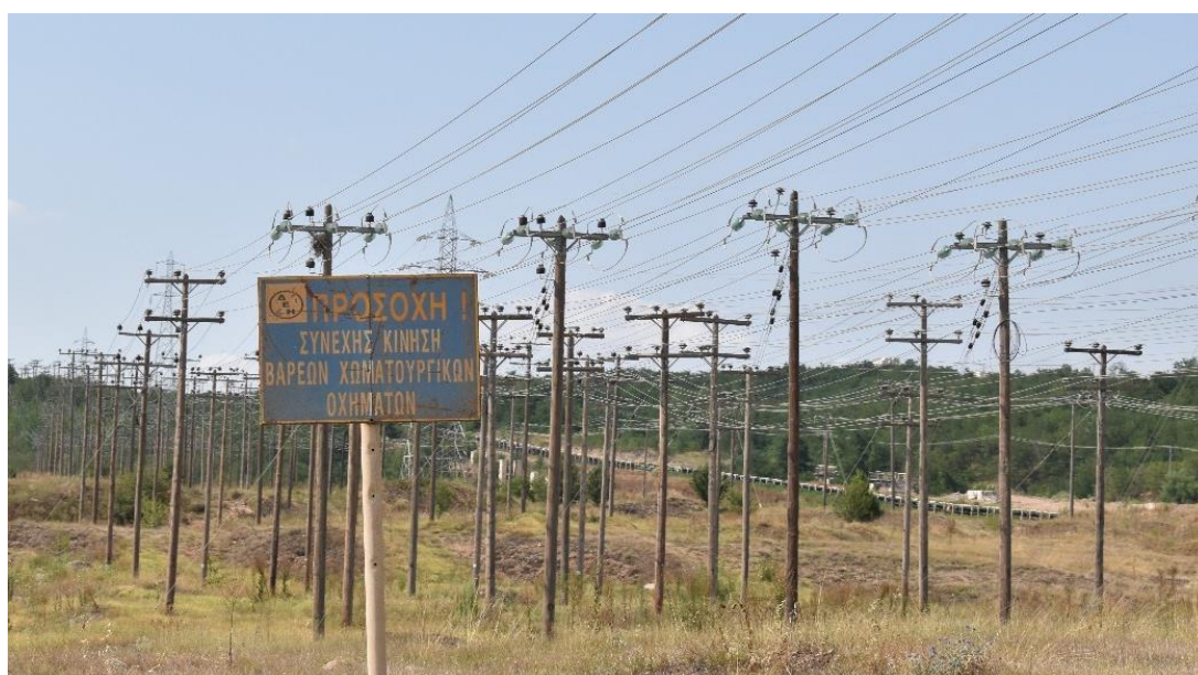
Εικόνα 7-18. Τμήμα του δικτύου ηλεκτρικής ενέργειας, ΛΚΔΜ, Δυτική Μακεδονία.
