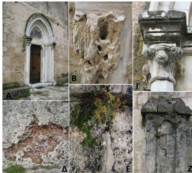
Εικόνα 8: Φαινόμενα βιοδιάβρωσης στην Ιερά Μονή της Αγίας Παρθένου στη Σερβία, Α) Αισθητικές αλλοιώσεις στο εξωτερικό του ναού, Β) Ρωγμές σε εμπρόσθια πρόσοψη, Γ) Σχηματισμός βιοφίλμ από μύκητες και λειχήνες, Δ) Σύνθεση βιολογικής πατίνας από κυανοβακτήρια, Ε) και Ζ) Ανάπτυξη βρύων και λειχήνων σε εξωτερικές επιφάνειες τοιχωμάτων (Stupar et al., 2014).
