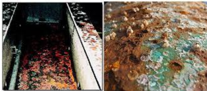
Εικόνα 1.4.8-α : Βακτηριακή διάβρωση
