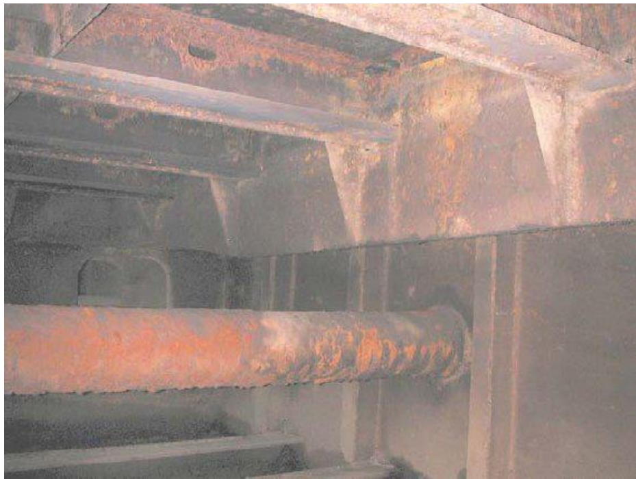
Εικόνα 2.4.5.3-γ : Δεξαμενή έρματος
