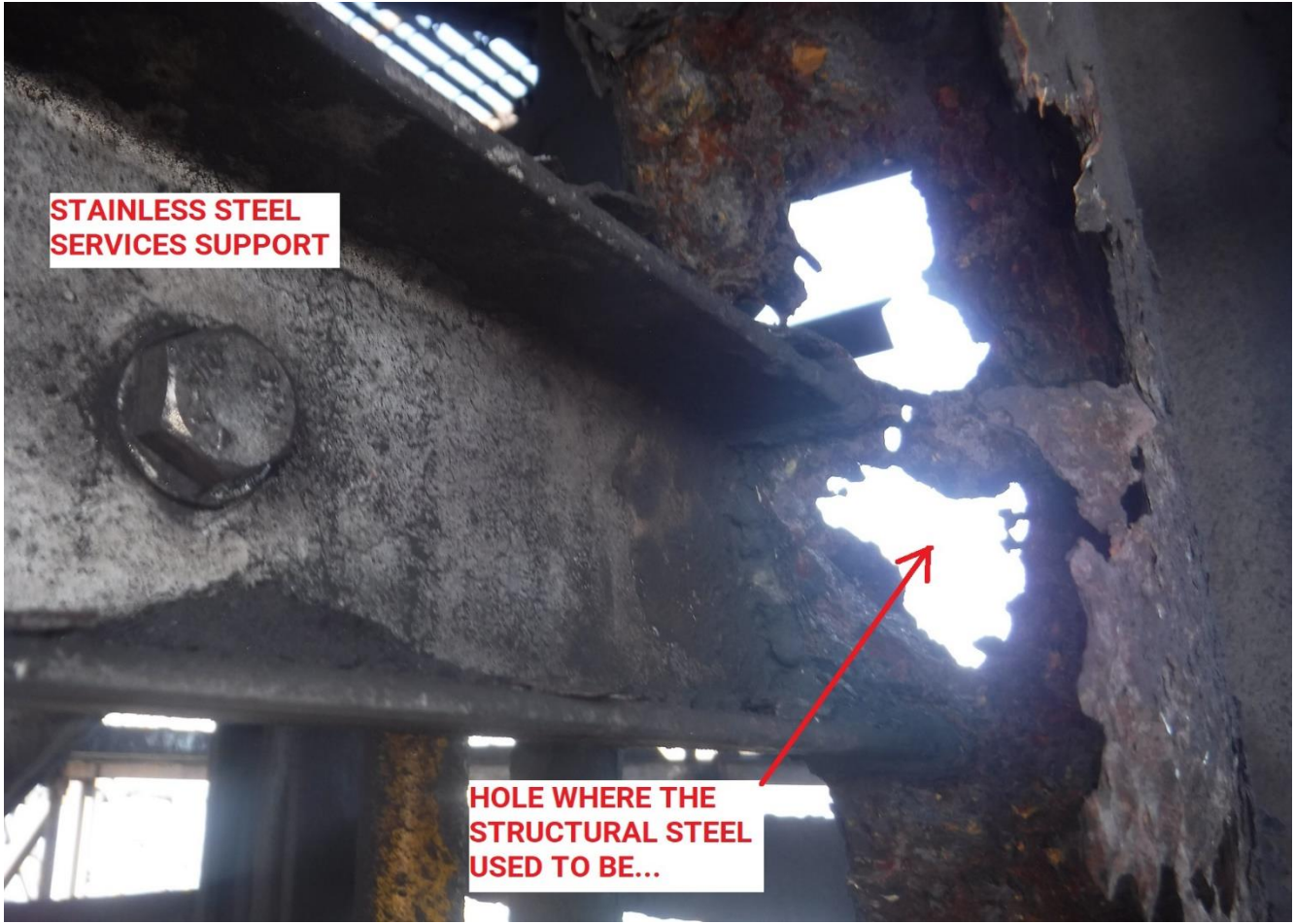
Εικόνα 1.4.3-α : Γαλβανική-διμεταλλική διάβρωση ( Ανοξείδωτος με Κοινό ναυπηγικό χάλυβα )
