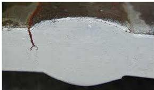
Εικόνα 1.4.6-β : Διάβρωση μηχανικής καταπόνησης
