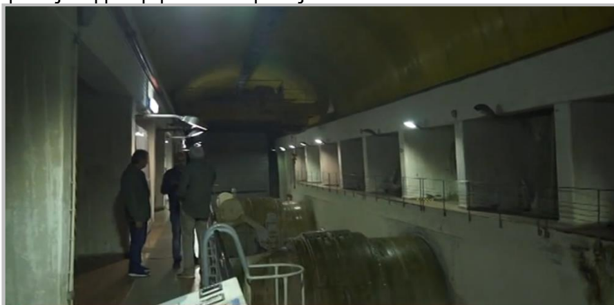
Εικόνα 70: Υπόγειος θάλαμος δικλείδων διαχείρισης ύδατος εντός ΥΗΣ Πολύφυτου - είσοδος προσπέλασης θαλάμου μέσω σηράγγων
