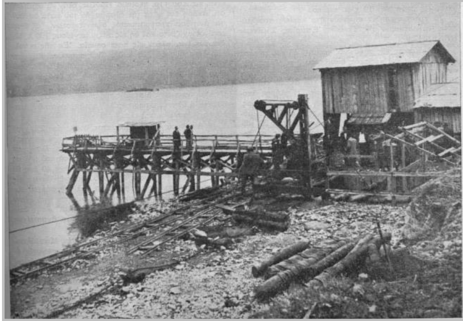
Εικόνα 124: Ερευνητικές γεωτρήσεις επί του πλησιέστερου της λίμνης υπερκείμενου εδάφους της σήραγγας στο εργοτάξιο Αρνίσσης του ΥΠΕ Άγρα (Αρχείο εγκαταστάσεων ΥΗΣ Λάδωνα ΔΕΗ ΑΕ)
