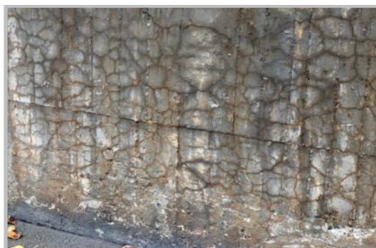
Εικόνα 26: Σχηματισμός ρωγμών σε δομή υπόγειας διάβασης λόγω αντίδρασης αλκαλικών συσσωματωμάτων (Τροποποιημένη εικόνα από αναφορά “Durability of shotcrete for underground support– Review and update”, Isabel Galan , Andre Baldermann, Wolfgang Kusterle, Martin Dietzel, Florian Mittermayr, Construction and Building Materials, Volume 202, 2019)
