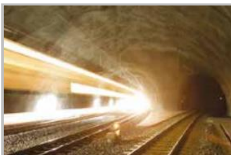
Εικόνα 7: Vereina- Ελβετία, σημείο διασταύρωσης ("Permanent Sprayed Concrete Linings", ITA Working Group 12 and ITAtech. - Longrine-Avignon, France: International Tunneling and Underground Space Association, 2020)
