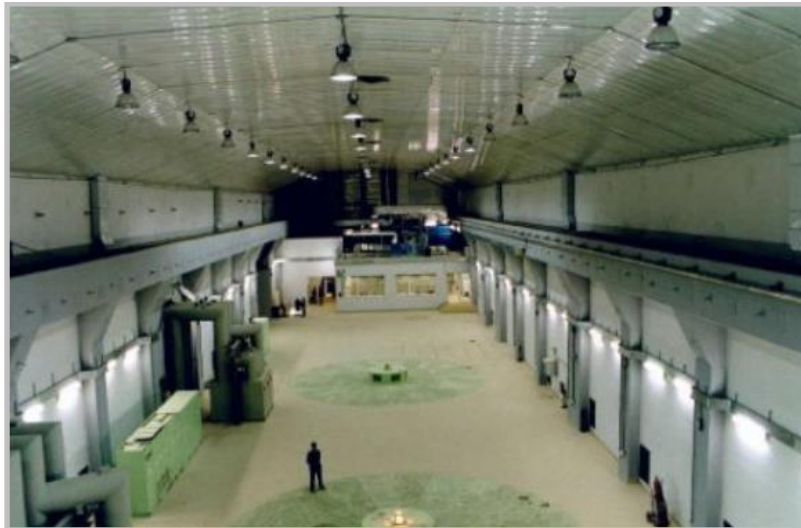
Εικόνα 82: Υπόγειος Σταθμός Παραγωγής ΥΗΕ Θησαυρού (Φωτογραφίες ΥΗΕ Θησαυρού - https://www.microhydropower.gr )
