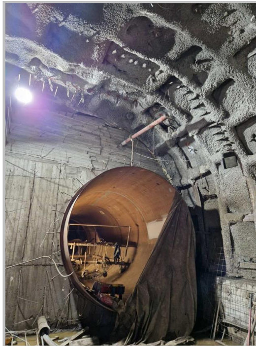
Εικόνα 106: Μεταλλική σήραγγα προσαγωγής (Φωτογραφικό υλικό ΔΕΗ ΑΕ)
