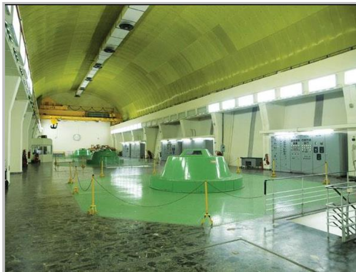
Εικόνα 66: ΥΗΣ Πολυφύτου (Υδροηλεκτρικός σταθμός Πολύφουτου ( wikimaria.org ))
