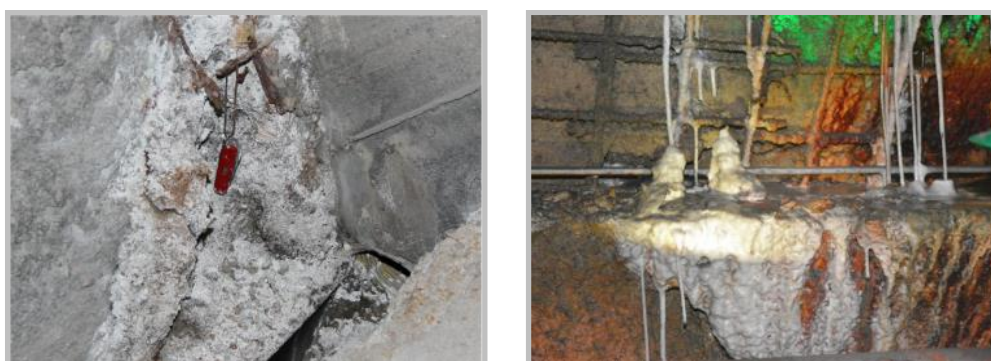
Εικόνα 25: Δείγματα διάβρωσης χάλυβα σε οπλισμένο εκτοξευόμενο σκυρόδεμα (Τροποποιημένη εικόνα από αναφορά “Durability of shotcrete for underground support– Review and update”, Isabel Galan , Andre Baldermann, Wolfgang Kusterle, Martin Dietzel, Florian Mittermayr, Construction and Building Materials, Volume 202, 2019)
