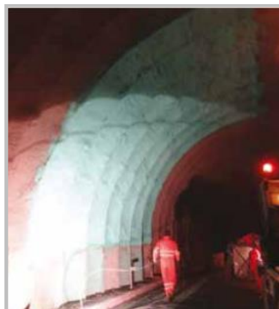
Εικόνα 8: Rivarolo-Ιταλία, εφαρμογή της υδατοστεγανής εκτοξευόμενης στρώσης ("Permanent Sprayed Concrete Linings", ITA Working Group 12 and ITAtech. - Longrine-Avignon, France: International Tunneling and Underground Space Association, 2020)
