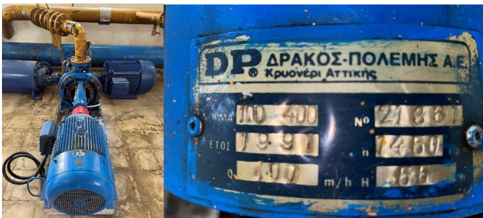
Εικόνα 3-6 Φωτογραφία της αντλίας P4 (Πηγή: Υπηρεσία Ηλεκτρομηχανολογικών Εγκαταστάσεων Ύδρευσης της Διεύθυνσης Δικτύου Ύδρευσης της ΕΥΔΑΠ).
