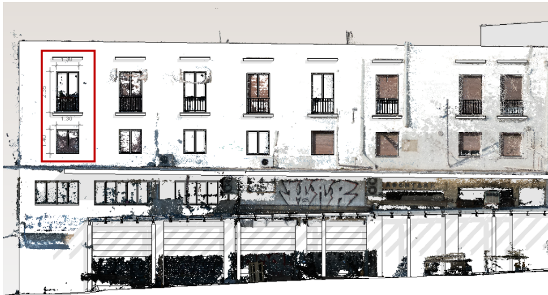
Εικόνα 4.3.8: Ενδεικτική περίπτωση κτηρίου: συμβολή οδών Σωκράτους και Αρμοδίου – ενδεικτικές περιπτώσεις ανοιγμάτων, Πηγή: Συγγραφέας
