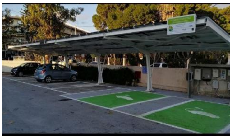
Εικόνα 10.10: Παράδειγμα Σταθμού φόρτισης αυτοκινήτων με φωτοβολταϊκά πάνελ Πηγή: greenagenda.g
