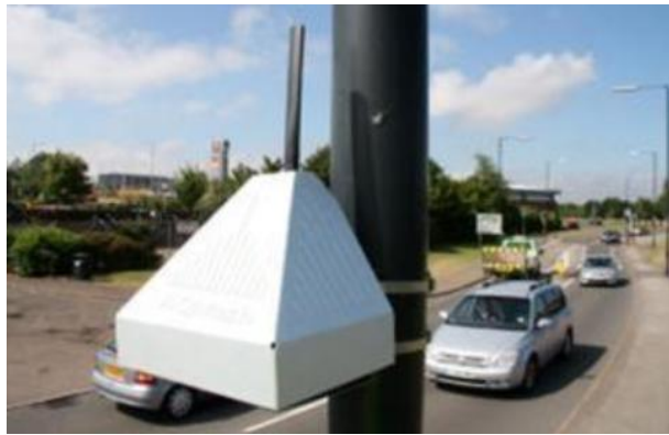
Εικόνα 10.6: Εγκατεστημένος πολυαισθητήρας παράλληλα με το δίκτυο ηλεκτροφωτισμού Πηγή: arta.gr
