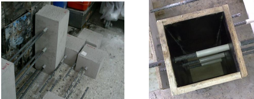
Εικόνα 2.8 (Αριστερά) Κυβικά δοκίμια και χαμηλό υποστρώμα λίγο μετά από την αφαίρεση των ξυλότυπων, (Δεξιά) ξυλότυπος χαμηλού υποστρώματος, όπου φαίνονται οι ράβδοι οπλισμού και οι σωλήνες για τον περιορισμό του μήκους συνάφειας.
