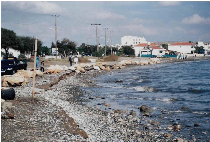
Εικόνα 4.13: Διάβρωση ακτής σε τμήμα της Υποπεριοχής 3
