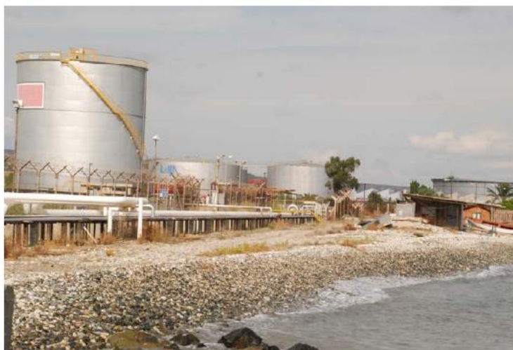
Εικόνα 4.22: Χερσαίοι αγωγοί μεταφοράς πετρελαϊκών προϊόντων κατά μήκος της παραλίας
