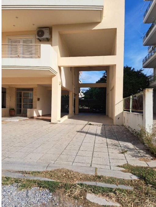
Εικόνα 6.43: Φωτογραφίες αυτοψίας στο ΟΤ 69 όπου φαίνονται οι στοές προς τον ΥΑΧ (Πηγή: Ιδία επεξεργασία)
