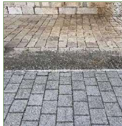
Εικόνα 162| Έλλειψη σύνδεσης πλακοστρώσεων στον Ιερό Ναό Ιωάννη Πρόδρομου (Προσωπικό Αρχείο, 04.2024)
