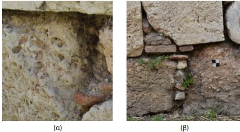
Εικόνα 4.1817: Παράδειγμα απώλειας πλίνθου (περιοχή ΤΧ3 λίθος 13)(α), Παράδειγμα απώλειας ιστορικού κονιάματος (περιοχή ΤΧ3)(β)
