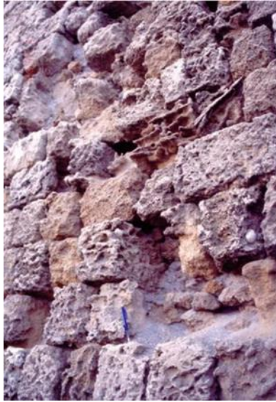
Εικόνα 2.10: Κρυστάλλωση αλάτων- Μεσαιωνική πόλη της Ρόδου, (Πηγή: Διδακτικές Σημειώσεις ΔΠΜΣ «Προστασία Μνημείων» Β' Κατεύθυνση, Καθ. ΕΜΠ Αντωνία Μοροπούλου).
