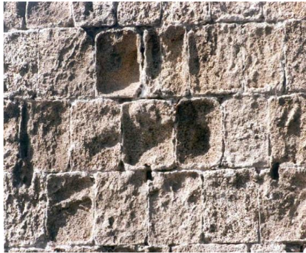
Εικόνα 2.12: Τοιχοποιία από Μεσαιωνικές οχυρώσεις Ρόδου, (Πηγή: Διδακτικές Σημειώσεις ΔΠΜΣ «Προστασία Μνημείων» Β' Κατεύθυνση, Συντήρησης Καθ. ΕΜΠ Αντωνία Μοροπούλου)
