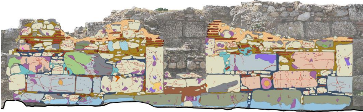
Εικόνα 5.78 (γ): Φθορές του νότιου τοίχου του κλιμακοστασίου και των προσόψεων των δωματίων 6-7-8, της Πλατείας Οδού
