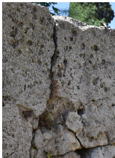
Εικόνα 4.155: Παράδειγμα ρωγμής, περιοχή ΤΧ1 λίθος 2
