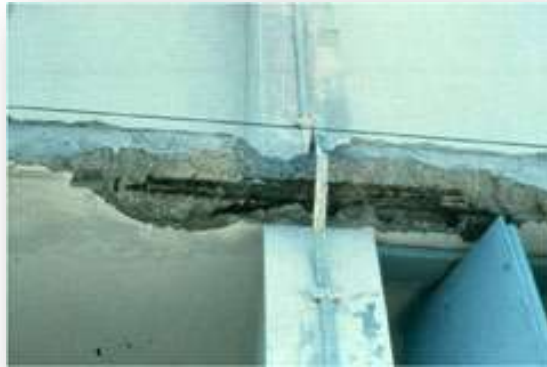
Εικόνα 3: Απόσχιση και εκτίναξη σκυροδέματος λόγω ενανθράκωσης
