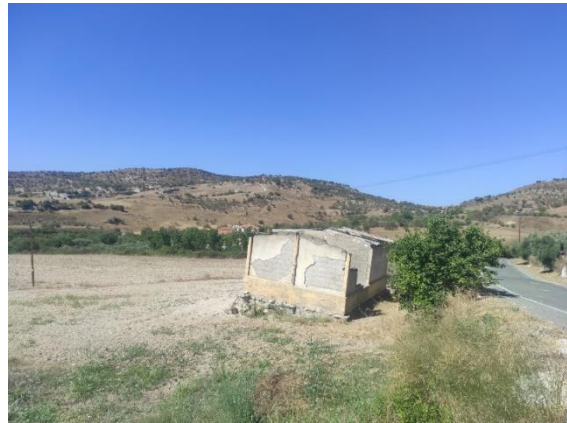
Εικόνα 18. (Δεξιά) Κτηριακή κατασκευή υπό κλίση λόγω των μετακινήσεων της κατολίσθησης
