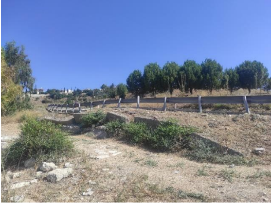
Εικόνα 17. (Αριστερά) Παραμόρφωση σε δρόμο στα όρια της κατολίσθησης
