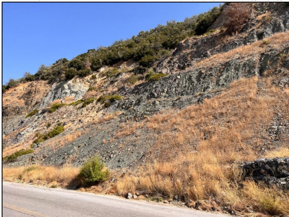
Εικόνα 3. 35: Παρουσιάζεται η έντονη κλίση της κατολίσθησης της Χ.Θ 3+400 έως Χ.Θ 3+600 καθώς και ο μεγάλος όγκος εδαφικών υλικών (πλευρικά κορήματα) που έχει συσσωρευθεί στο πόδα του πρανούς.
