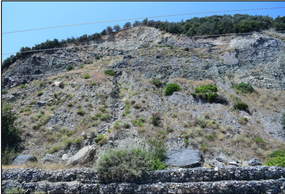
Εικόνα 3. 34: Στη συγκεκριμένη εικόνα διακρίνεται το ύψος της κατολίσθησης γύρω από την Χ.Θ 3+500. Ακόμη, στον πόδα φαίνεται η κατασκευαστική παρέμβαση με συρματοκιβώτια και παράλληλα τα εδαφικά υλικά κατολίσθησης σε συνδυασμό με μεγάλα τεμάχια βράχου.
