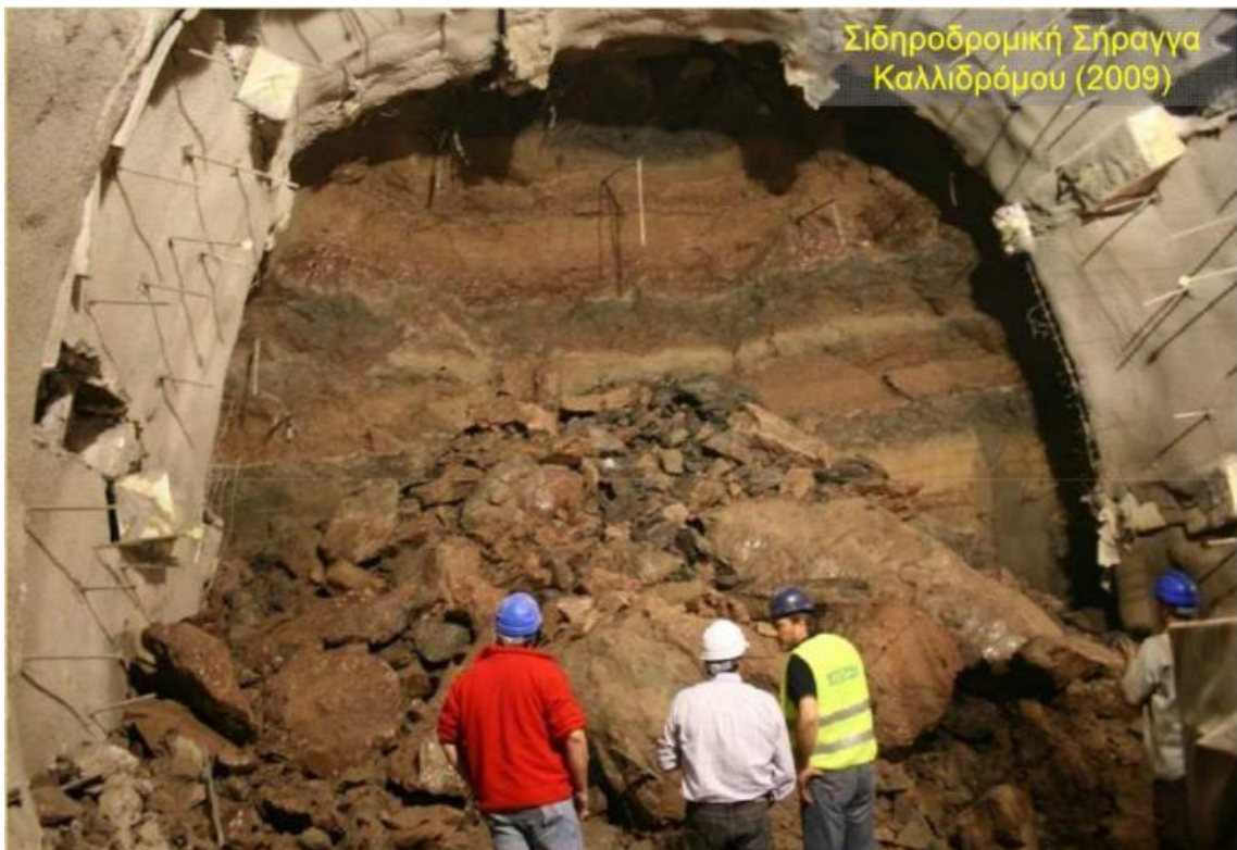
Εικόνα 2. 6: Αστοχία μετώπου της σιδηροδρομικής σήραγγας Καλλιδρόμου (Καθβαδάς Μ., 2012).
