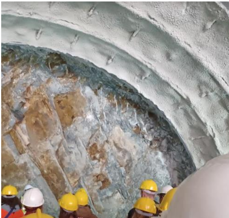
Εικόνα 2. 10: Ελαφρά βλήτρα προπορείας και μεταλλικά πλαίσια κοντά στο μέτωπο εκσκαφής (προσωπικό αρχείο).
