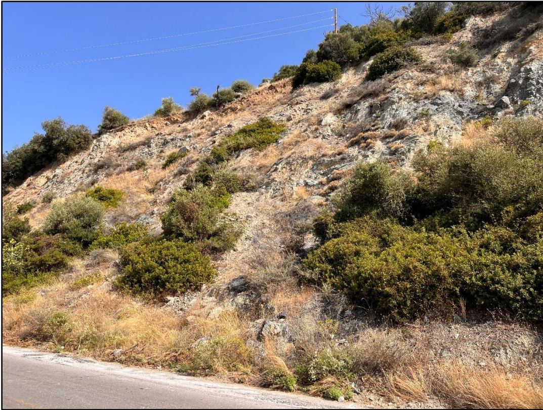
Εικόνα 3. 37: Παρουσιάζεται το πρηνές της Χ.Θ 3+900 με σχηματισμό πρασινοσχιστόλιθου με σχετικά χαμηλά υπερκείμενα, μέτρια κλίση και αστοχίες που εκδηλώνονται κυρίως με τη μορφή ρωών εδαφικών υλικών και καταπτώσεων μικρών βραχωδών τεμαχών.
