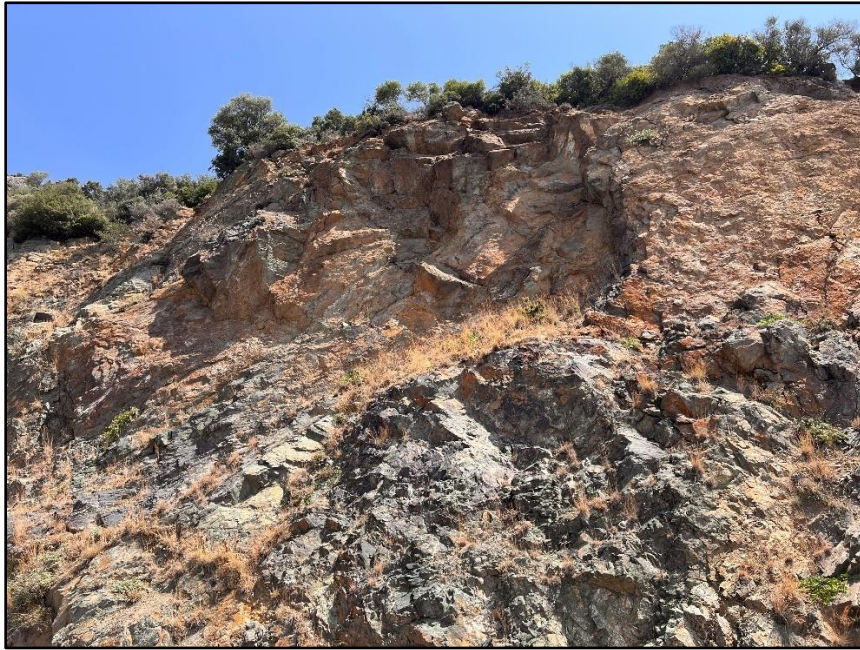
Εικόνα 3. 25: Επίπεδη ολίσθηση και ανατροπές σε σχηματισμό πρασινιτών - πρασινοσχιστόλιθων στο τμήμα Χ.Θ 0+250 έως Χ.Θ 0+350.
