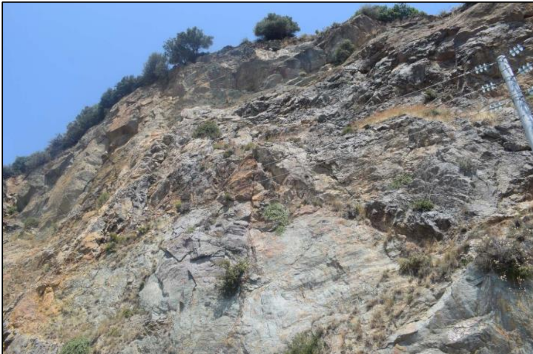
Εικόνα 4. 5: A1 Τεμαχώδης – Πολύ Τεμαχώδης Ασβεστολιθική βραχομάζα όπου διακρίνονται οι βαρυτικές αστοχίες (περί Χ.Θ. 0+900).
