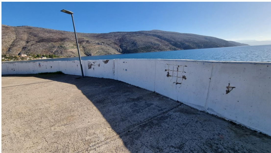
Εικόνα 4-14. Φθорές προφυλακτήριου τοίχου-εμφάνιση οπλισμού, λιμένας Παραλίας Σαράντη, ίδια φωτογράφιση.
