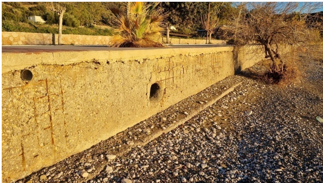
Εικόνα 4-17. Φθορές διαχωριστικού τοίχου παραλιακής οδού-ακτή, ίδια φωτογράφιση.
