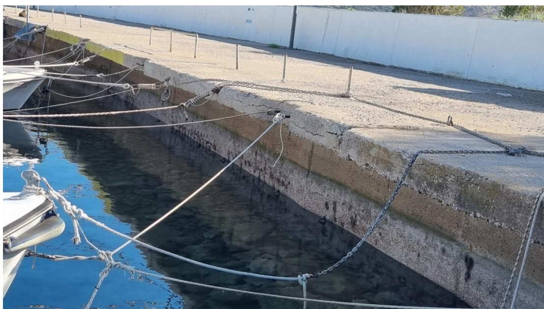
Εικόνα 4-13. Φθορές αποβάθρας Λιμένα Παραλίας Σαράντη, ίδια φωτογράφιση.
