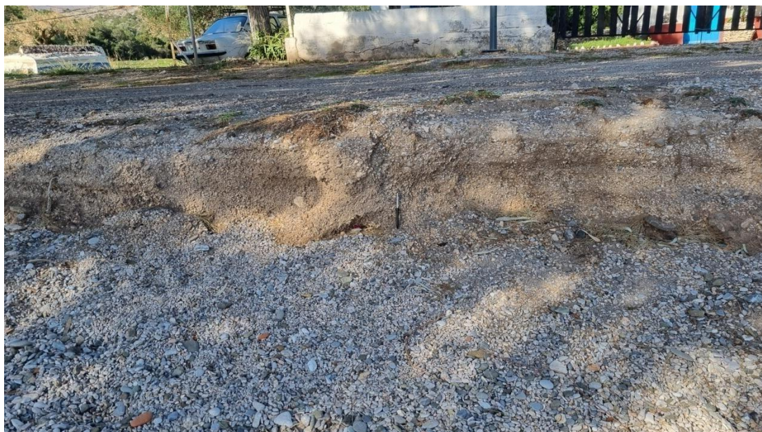
Εικόνα 4-11. Διάβρωση οδοστρώματος από ασύνδετα υλικά, ίδια φωτογράφιση.
