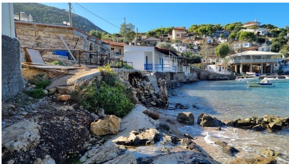
Εικόνα 4-47. Φθορές σε κατασκευές στο νότιο τμήμα της ακτογραμμής Αγίου Βασιλείου, ίδια φωτογράφιση.
