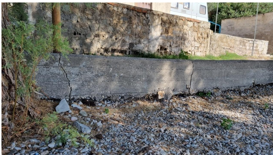
Εικόνα 4-38. Φθорές τοίχου και υποσκαφή αντιστήριξης οδού, ίδια φωτογράφιση.
