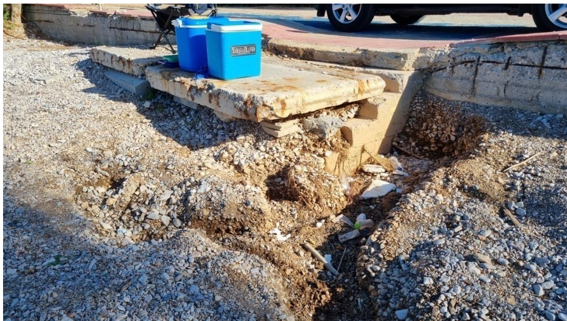
Εικόνα 4-46. Διάβρωση τμήματος της ακτογραμμής Αγίου Βασιλείου, ίδια φωτογράφιση.
