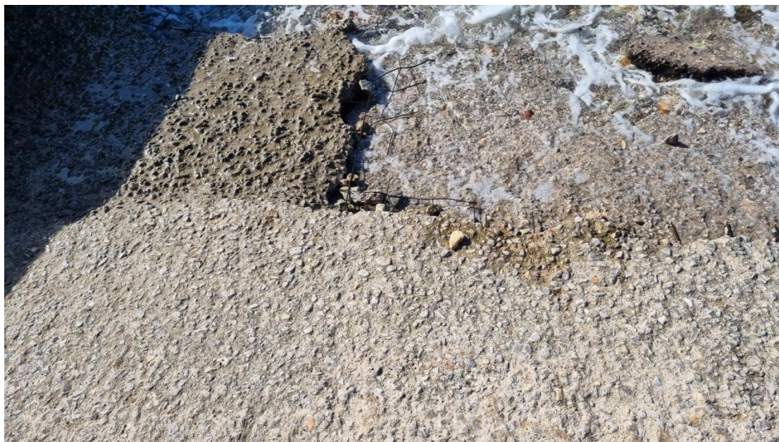
Εικόνα 4-41. Φθορές κεκλιμένου επίπεδου ανέλκυσης-καθέλκυσης σκαφών στο ανατολικό τμήμα της ακτής, ίδια φωτογράφιση.
