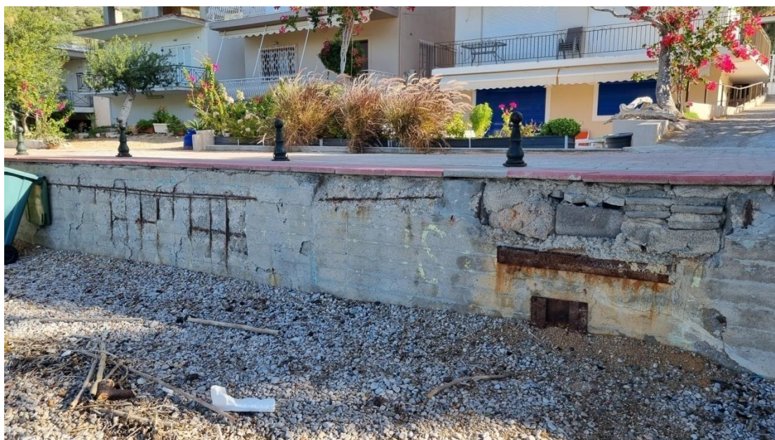
Εικόνα 4-45. Φθορές στον κατακόρυφο τοίχο κατά μήκος της ακτογραμμής, ίδια φωτογράφιση.
