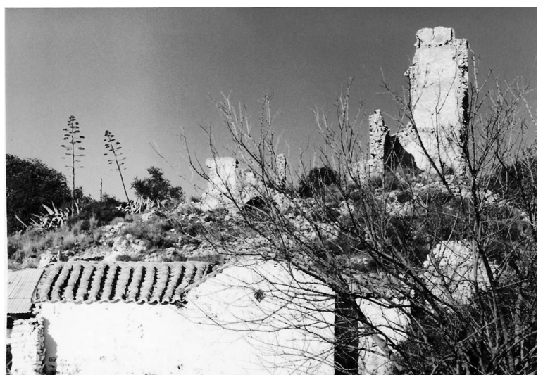
εικόνα 35, νότια άποψη του ναού με το στέγαστρο από ελενίτ της δεκαετίας του '80, Μηνάιος Η., Αγία Σωτήρα Ασίνης, Ιστορία-μύθος-παραδόσεις, 2020
