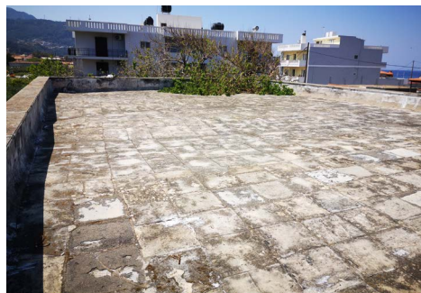
Εικ. 6.4 Υφιστάμενη κατάσταση δώματος με εμφανή την εκτεταμένη χρήση τσιμεντοκονιαμάτων_Πηγή: προσωπικό αρχείο
