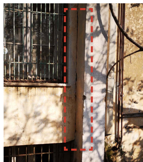
Εικ. 5.4 Κατακόρυφη ρηγματώση στο σημείο σύνδεσης της καπνοδόχου με την περιμετρική τοιχοποιία_Πηγή: προσωπικό αρχείο
