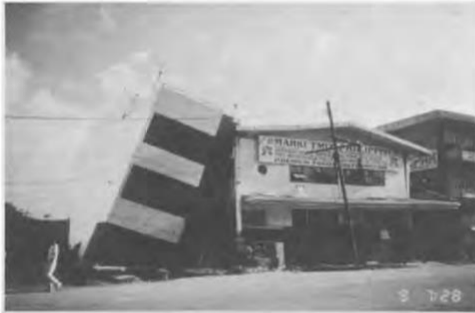
Σχήμα 2.2: Ζημία σε κτίριο προκλιθείσα από γειτονικό κτίριο στον σεισμό του Luzon το 1990 (Tokimatsu et.al. 1991)
