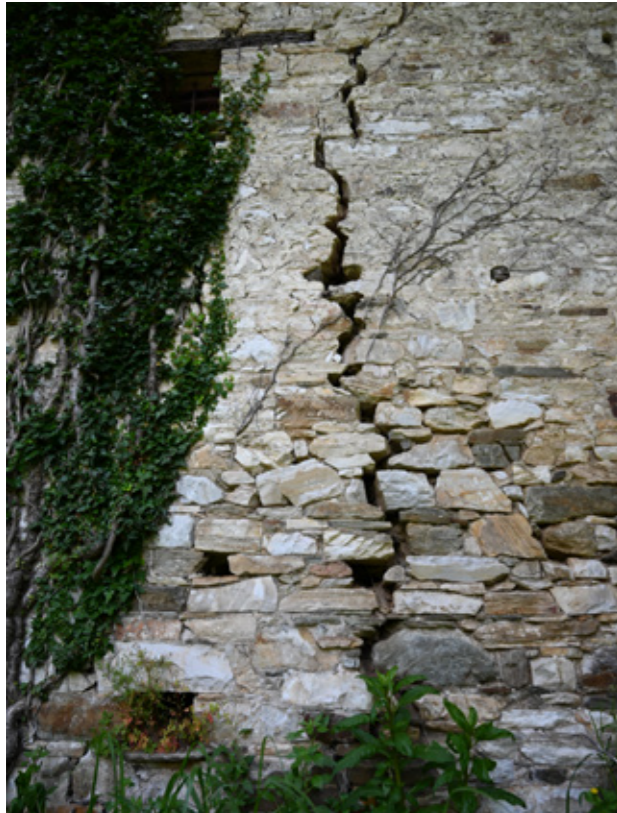
Εικ.256| Δυτική πτέρυγα, εξωτερική όψη, ρωγμή. 05/2023.
