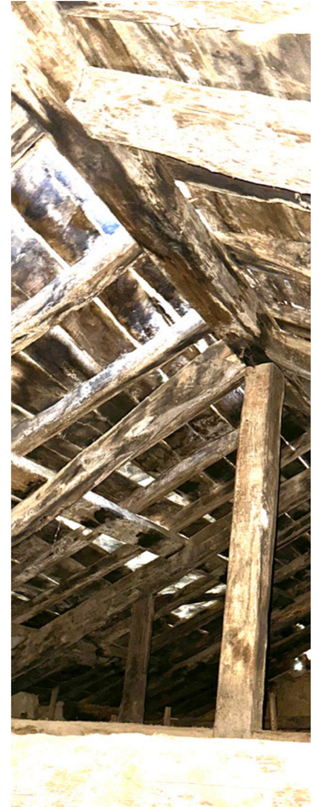
Εικ.218| Εσωτερικό της στέγης προς ΝΔ. Διακρίνονται οι βλάβες στο πέτσωμα. 02/2024.
