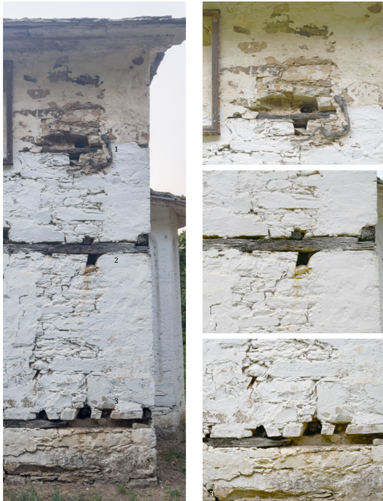
Εικ.180 | Ρωγμή 5, Ν όψη. 02/2024.
