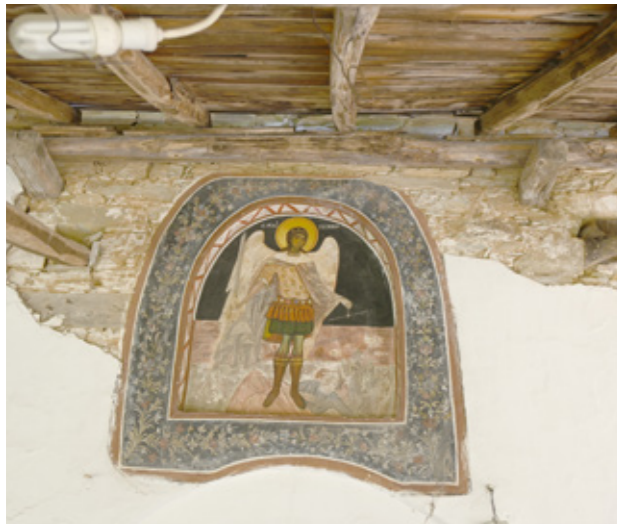
Εικ.165 | Απώλεια επιχρίσματος, Δ όψη. 08/2023.
