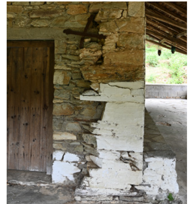
Εικ.203| Διακρίνεται η ρωγμή ανάμεσα στον παλιό και τον "νέο" τοίχο. 08/2023.
