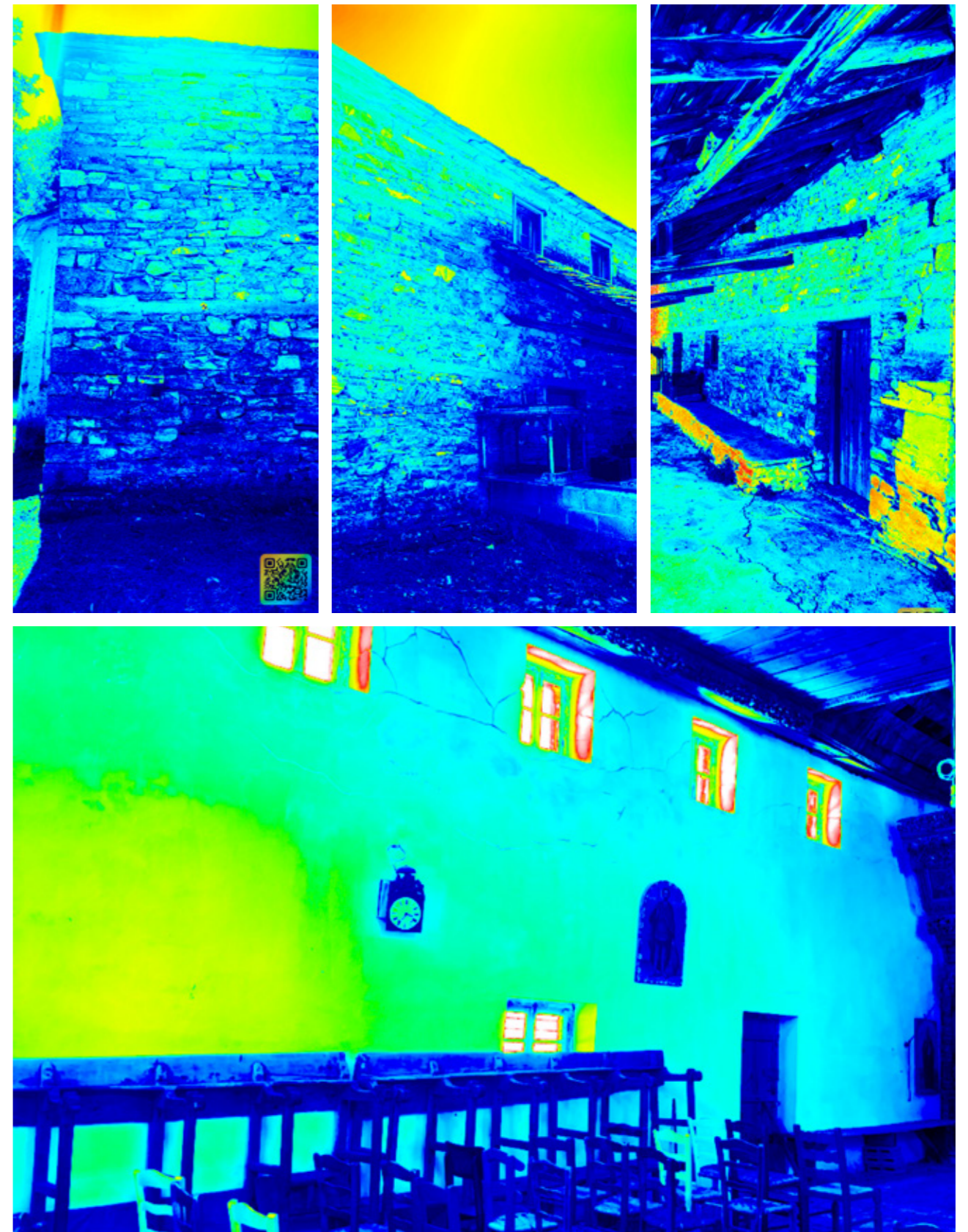
Εικ.206 | Αποτύπωση υγρασίας μέσω θερμοφωτογραφίας. 08/2024.
