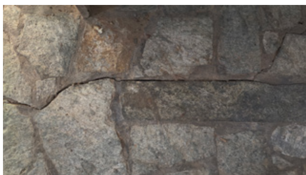
Εικ.90| Το δάπεδο στη Δ πλευρά του κυρίως ναού. Πάνω: 1973-76, μέση: 08/2023, κάτω: ρωγμή στους αρμούς, 08/2024.
