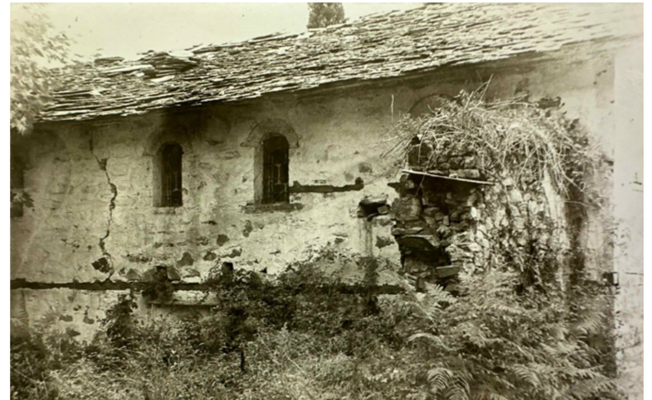
Εικ.173 | Φωτογραφία όπου φαίνεται πως η ρωγμή 4 υπήρχε ήδη τη δεκαετία του 1970.
