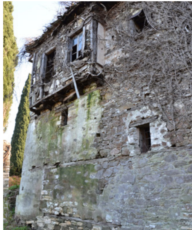
Εικ.232 | Η εξωτερική όψη της βόρειας πτέρυγας. Η ξύλινη κατασκευή (σαχνισί) κατέρρευσε τον χειμώνα 2023-2024. Φωτογραφία: Σ. Μαμαλούκος, 12/2019.
