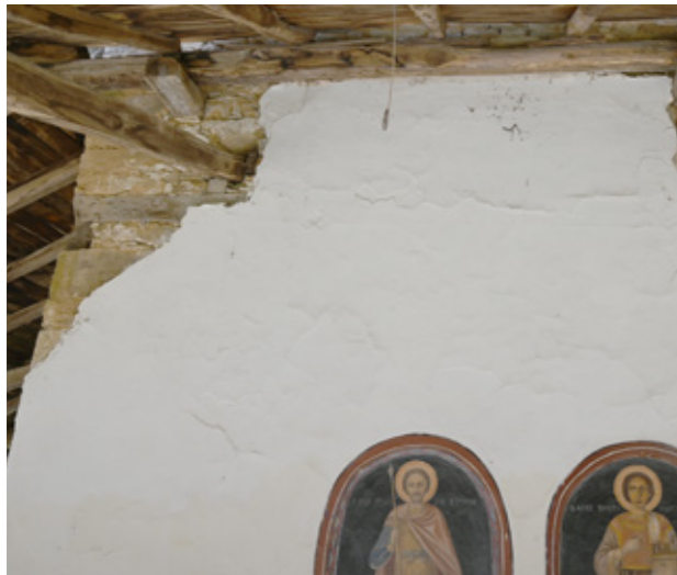
Εικ.164 | Ρωγμές επιχρίσματος, Δ όψη. 08/2023.
