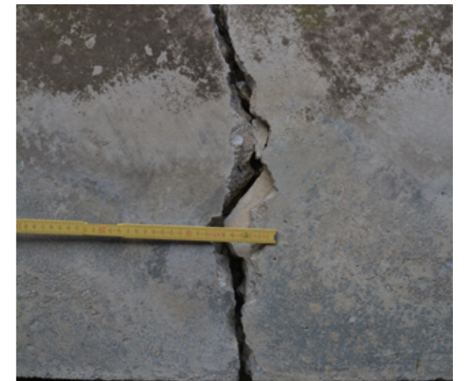
Εικ.222| Ρωγμή στο στηθαίο του περιστώ. 08/2023.
