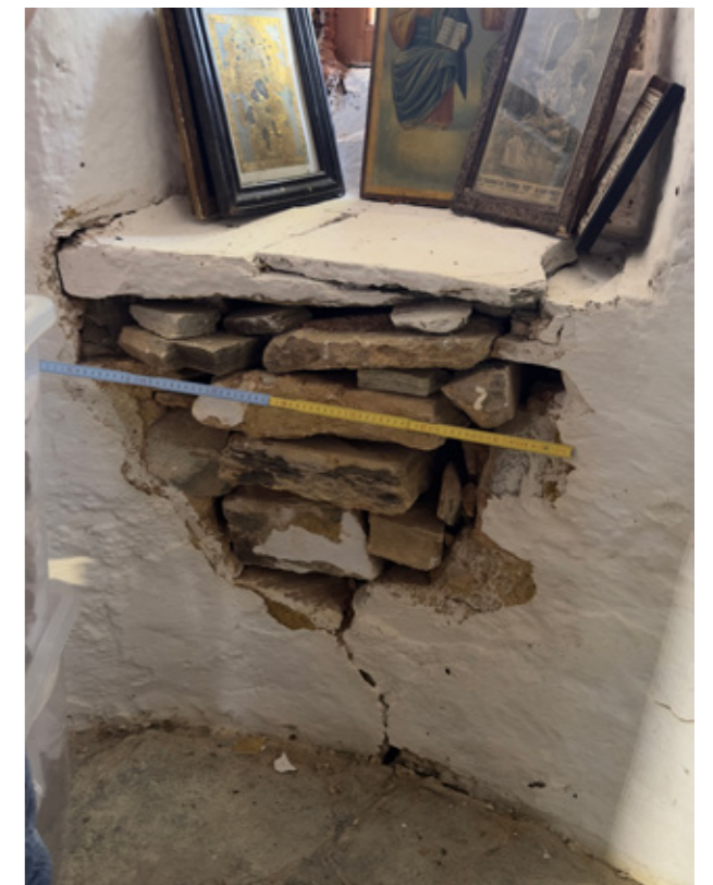
Εικ.199 | Ρωγμή στο κέντρο του θόλου της κόγχης του ιερού. 08/2023.
