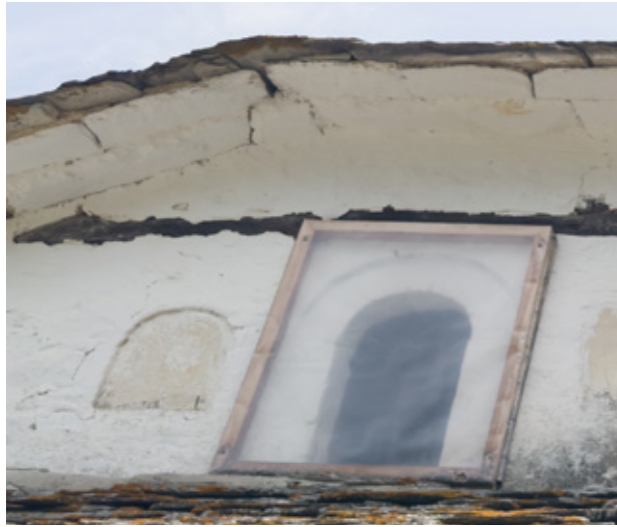
Εικ.163 | Ρωγμές, Δ όψη. 08/2023.
