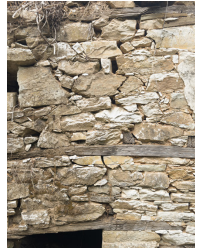
Εικ.259| Βόρεια πτέρυγα, εσωτερική όψη, ρωγμή. 08/2023.
