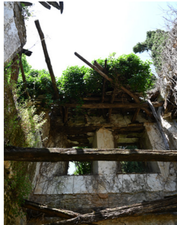
Εικ.263| Κ109, ΒΔ γωνία. Καταρρεύσεις πατώματος, στέγης, κλπ. 05/2023.
