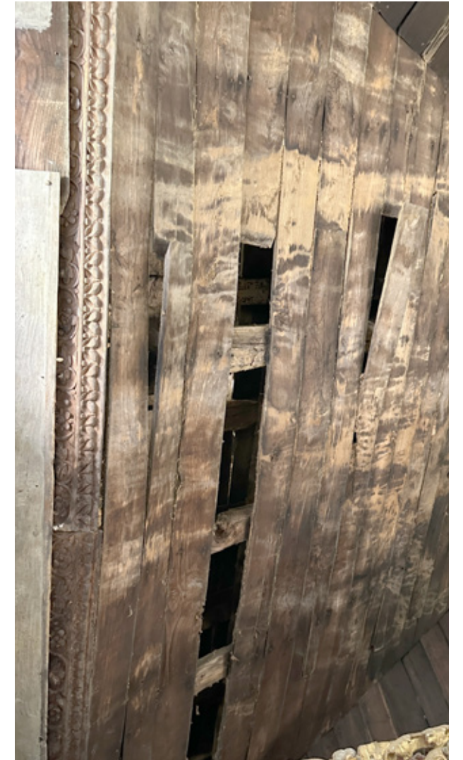
Εικ.215 | Ψευδοθόλος προς Ν. Απώλεια και, αποκολληση σανίδας, παθολογία υλικού λόγω υγρασίας. 08/2023.
