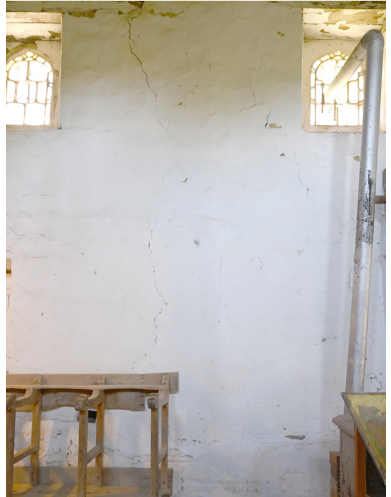
Εικ.179| Ρωγμή 4, Ν όψη. 08/2024.
