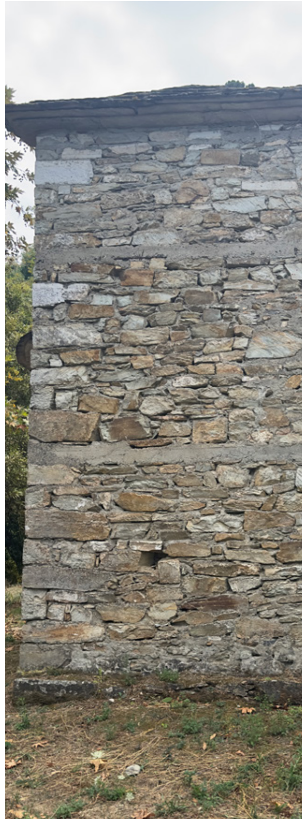
Εικ.200| Διακρίνεται η ρωγμή. 08/2023.
