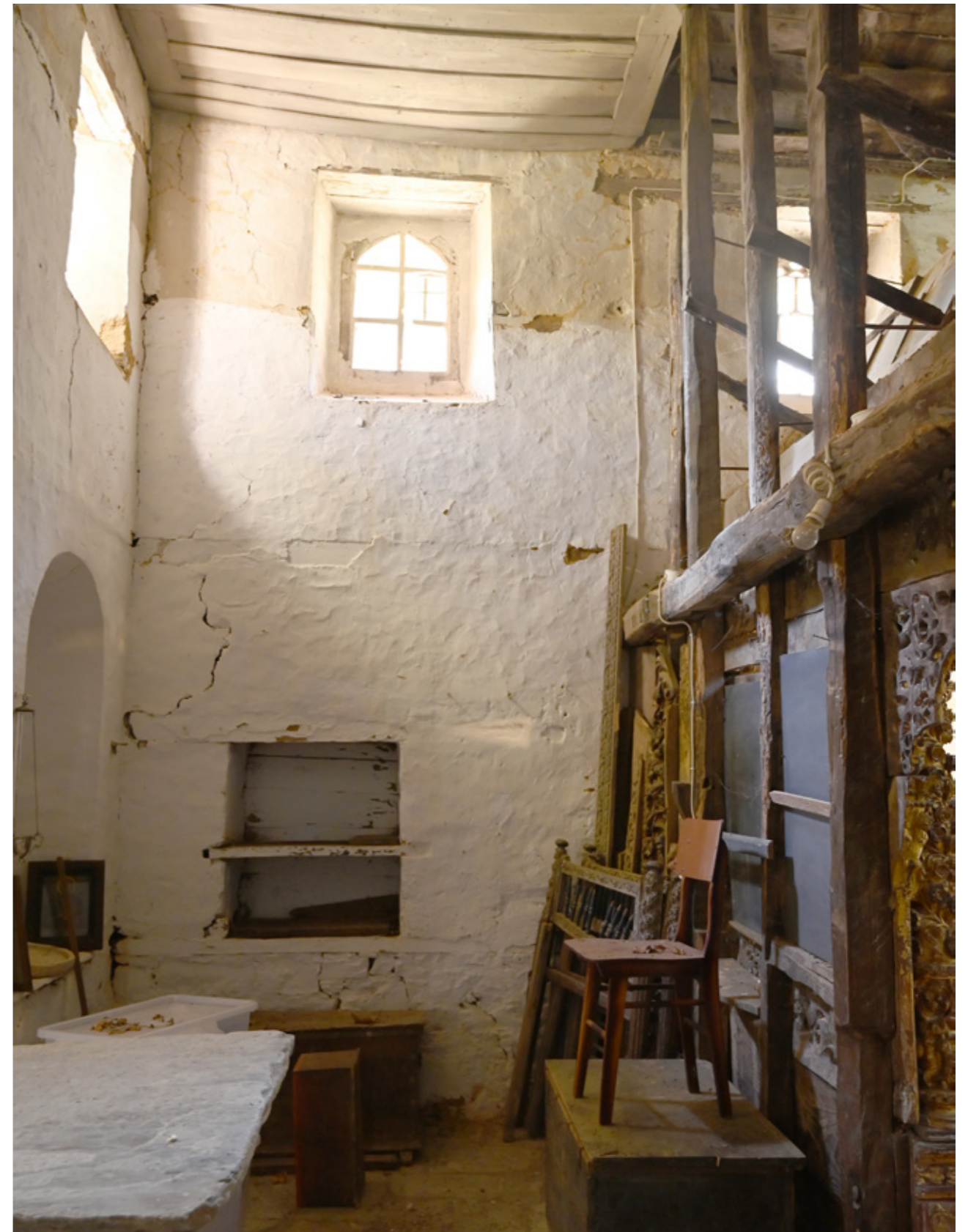
Εικ.181 | Ρωγμή 5, Ν όψη. 02/2024.
