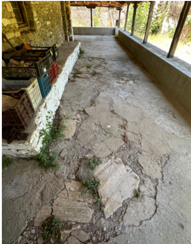
Εικ.220| Παθολογία δαπέδου περιστώ. Ρωγμές, βλάστηση, υγρασία. 08/2024.
