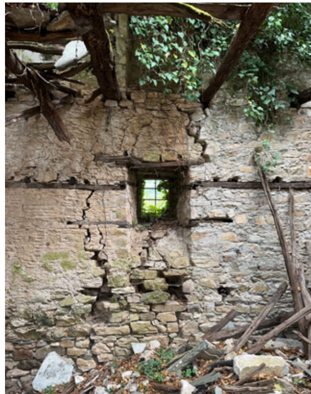
Εικ.262| Δυτική πτέρυγα, ρωγμές, αποδιοργάνωση λιθοδομής, κλπ. 08/2023.
