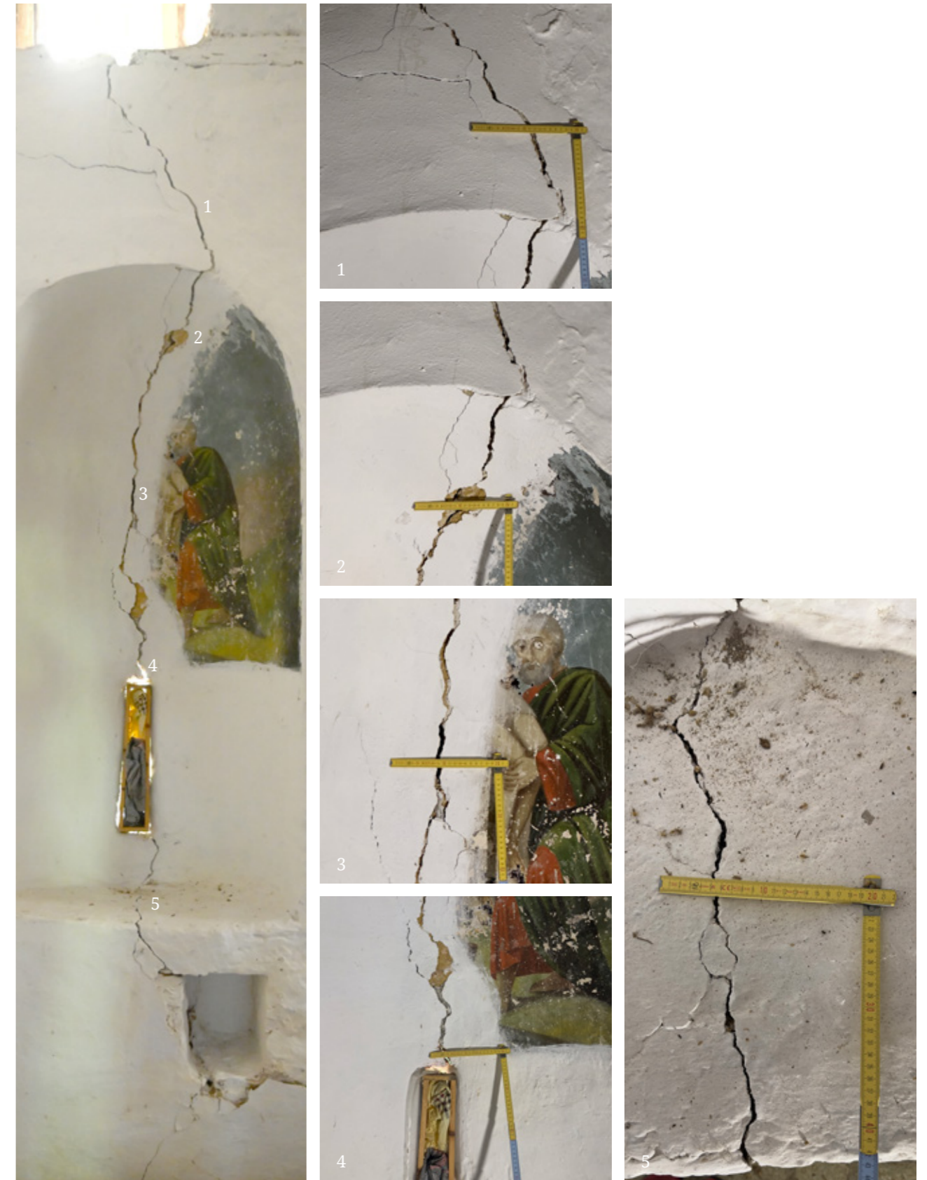
Εικ.193 | Ρωγμή στη σύνδεση παλαιού- "νέου" τοίχου. 08/2023.
