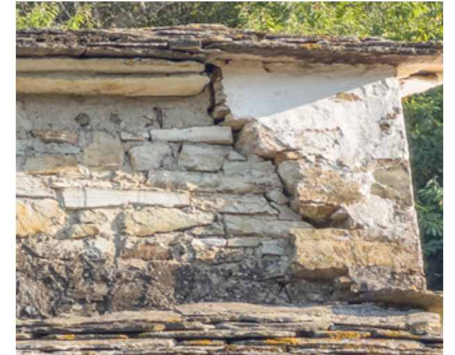
Εικ.201| Διακρίνεται η ρωγμή ανάμεσα στον παλιό και τον "νέο" τοίχο. 08/2023.
