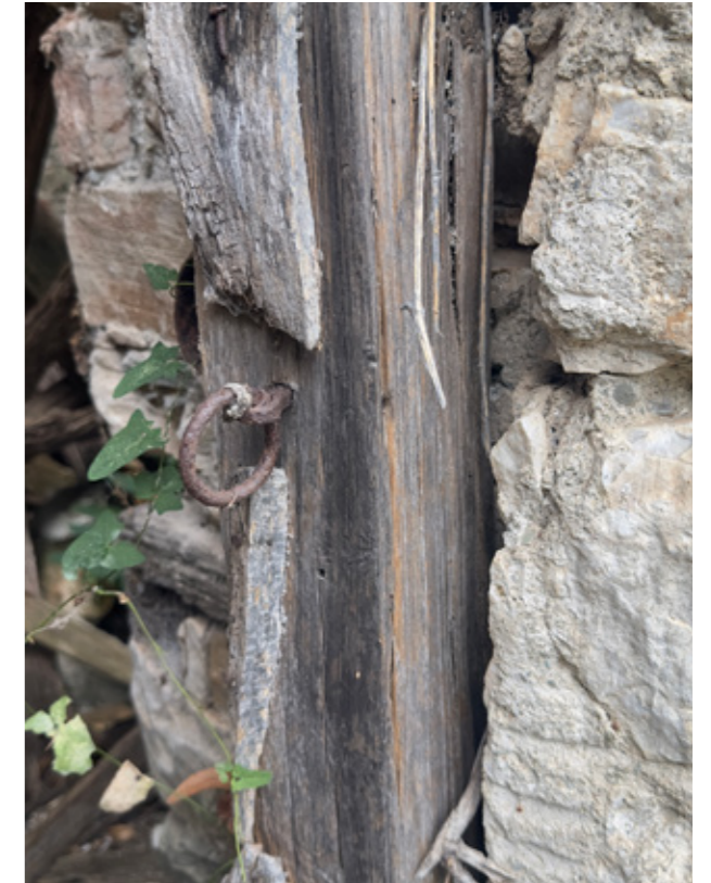
Εικ.265| Οξείδωση μεταλλικού κρίκου θύρας. 08/2023.
