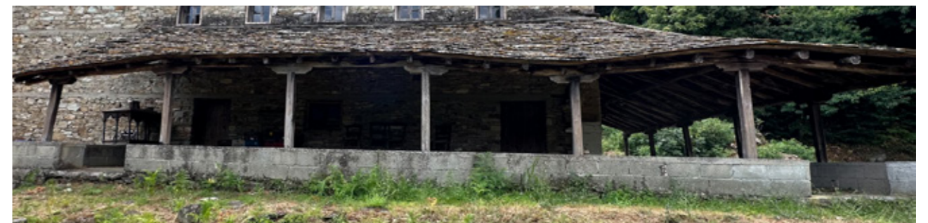
Εικ.204| Η αστοχία της στέγης του περίστωου. 08/2023.
