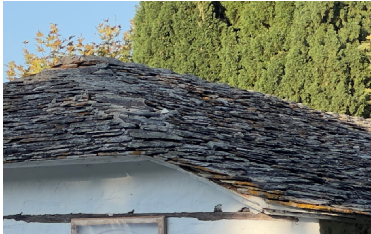
Εικ.216| Διακρίνεται τσιμέντο ανάμεσα στις πλάκες. 08/2023.
