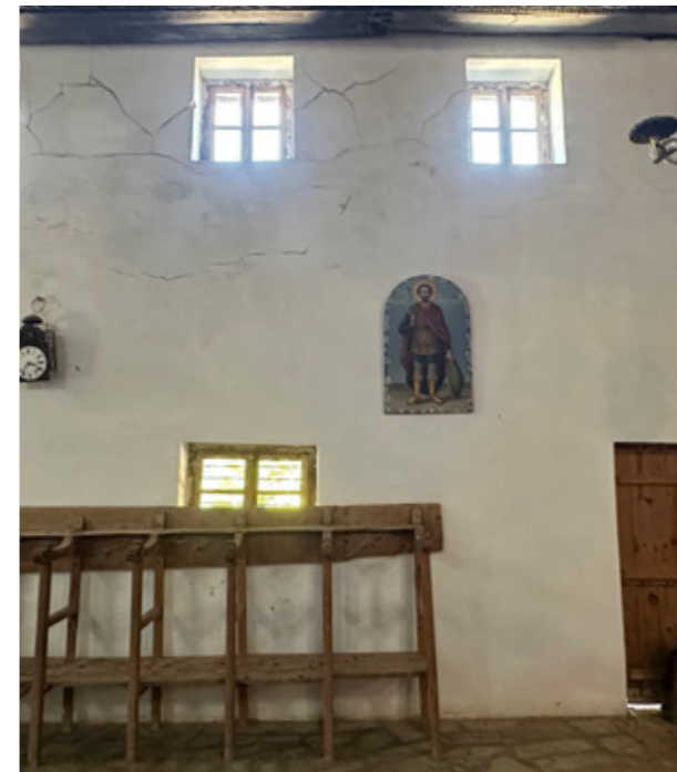
Εικ.202| Βόρεια όψη εσωτερικό. Διακρίνονται ρωγμές στο επίχρισμα και υγρασία. 08/2023.
