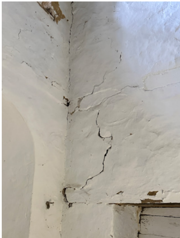
Εικ.184 | Ρωγμή 5, ΝΑ γωνία εσωτερικά. 02/2024.
