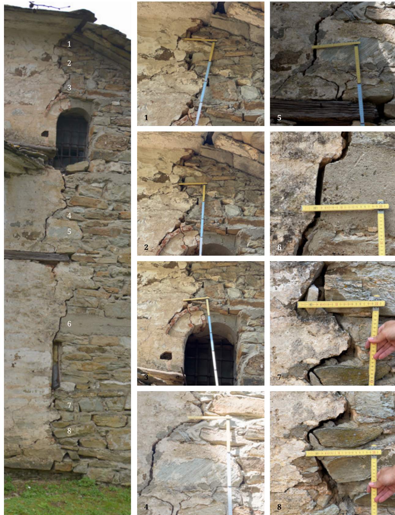
Εικ.192 | Ρωγμή στη σύνδεση παλαιού- "νέου" τοίχου. 08/2023.
