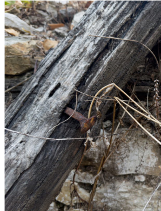
Εικ.264| Οξείδωση μεταλλικού καρφιού. 08/2023.
