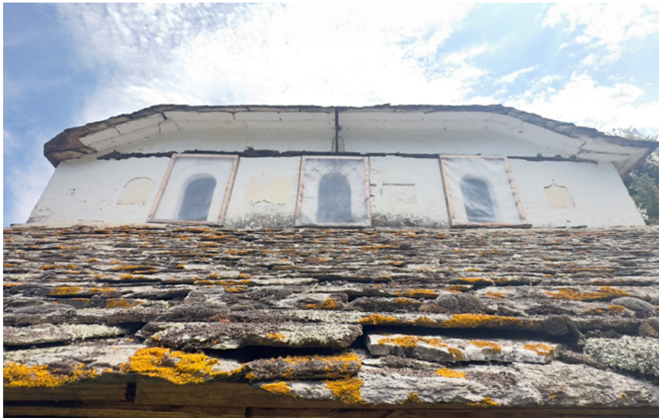
Εικ.170| Βλάστηση στις πλάκες της στέγης, τσιμέντο κορυφή της στέγης και λεκέδες υγρασίας. 02/2024.
