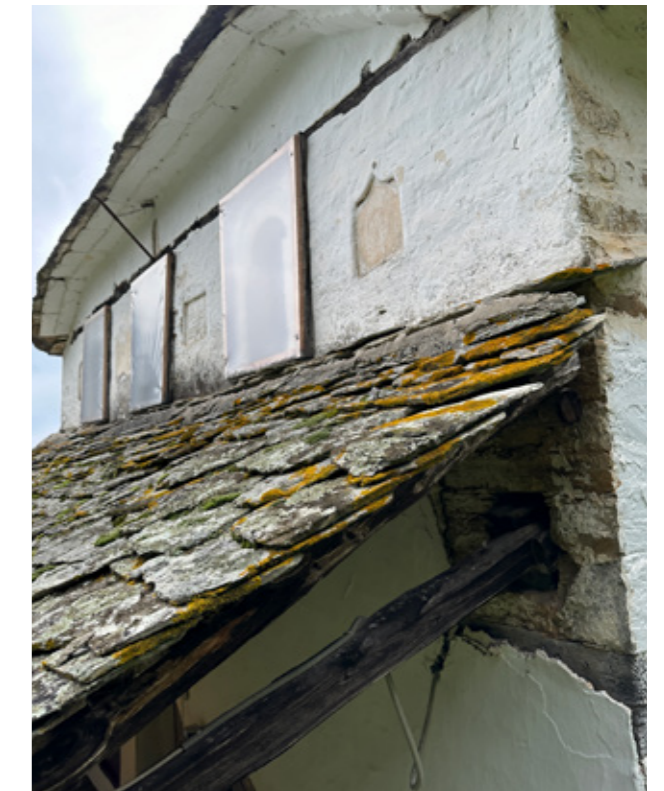
Εικ.160| Δ όψη, διακρίνεται το τσιμέντο στη στέγη, και οι παλιές πλάκες. 02/2024.
