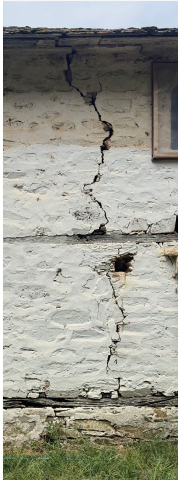
Εικ.178| Ρωγμή 4, Ν όψη.
