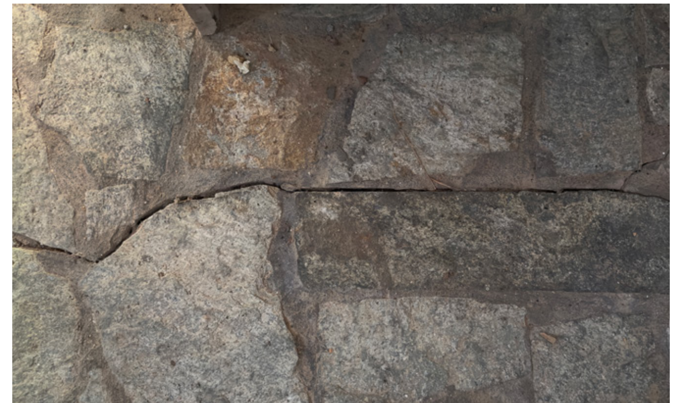
Εικ.207| Ρωγμή στο δάπεδο, κοντά στη δυτική όψη, βορείως της Θ101. Παρατηρήθηκε πρώτη φορά τον Αύγουστο 2024, σίγουρα δεν υπήρχε τον Φεβρουάριο του ίδιου έτους. Πάνω: λεπτομέρεια της σχισμής όπου φαίνεται πως το υπόστρωμα είναι μάλλον χώμα, κάτω: γενική φωτογραφία της ρωγμής. 08/2024.
