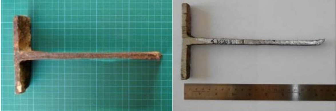
Εικόνα 9 Σ-1020δ: Τμήμα μεταλλικού στρεπτοσυνδέσμου (Αρχιτεκτονικό Μέλος: ΔΤΥ5) και δεξιά το δείγμα που αποκόπηκε.
