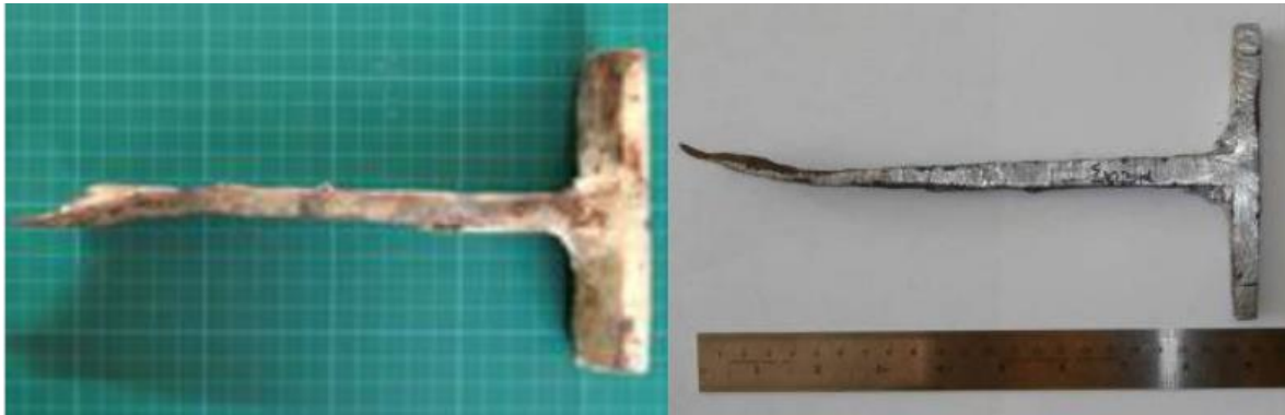
Εικόνα 7 Σ-1020α: Τμήμα μεταλλικού στρεπτοσυνδέσμου (Αρχιτεκτονικό Μέλος: Δ.ΤΑ3.6) και δεξιά το δείγμα που αποκόπηκε.
