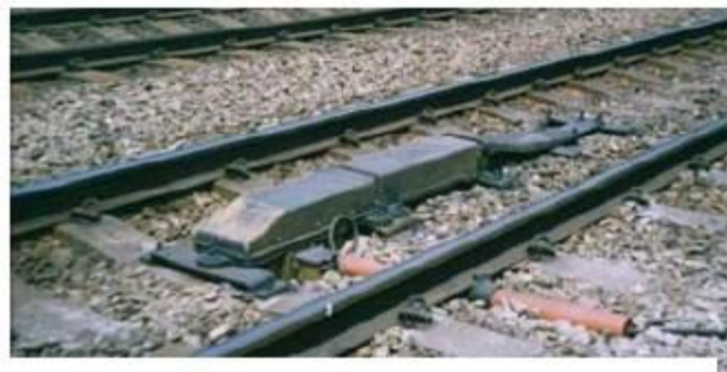
Ράμπα συστήματος AWS μεταξύ των σιδηροτροχιών
