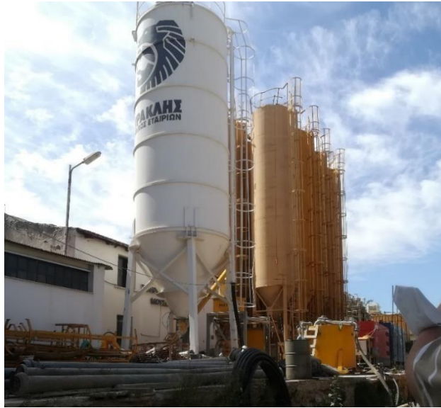
Εικόνα 4.10: Σιλό αποθήκευσης μπεντονιτικού διαλύματος
