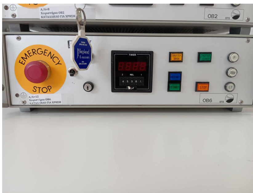
Εικόνα 4.19: Συσκευή ελέγχου λειτουργίας της Πηγής.
