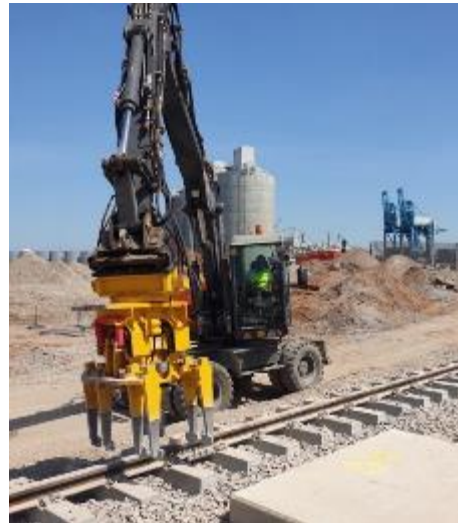
Εικόνα 1.32 Υπογόμευση στρωτήρων κατά το τελικό στάδιο κατασκευής τους στο λιμάνι του Λίβερπουλ [Πηγή: Bemo Rail]
