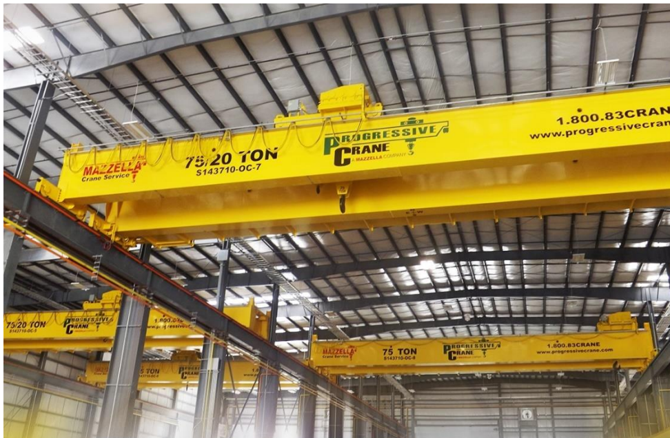
Εικόνα 1: Χρήση μεταλλικών δοκών σε γερανογέφυρα
