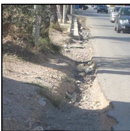
Εικ 18. Ανύπαρκτο πεζοδρόμιο επί της οδού Καραμανλή
