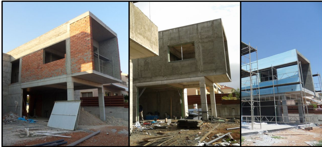
Εικόνα 2.23: Εξωτερικοί τοίχοι πλήρωσης κτισμένοι: α) με Κυπριακό τυπικό τούβλο στο πλάτος των φερόντων στοιχείων (αριστερά), β) με εξωτερικό επίχρισμα (μέση) και γ) με όλες τις εξωτερικές επιφάνειες να καλύπτονται με θερμομονωτικές πλάκες (δεξιά).
