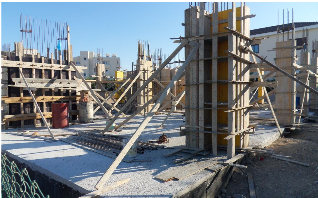
Εικόνα 4.16: Ολοκλήρωση της κατασκευής καλουπιού κολώνων ισογείου μέχρι το ύψος των δοκών της άνωθεν πλάκας.
