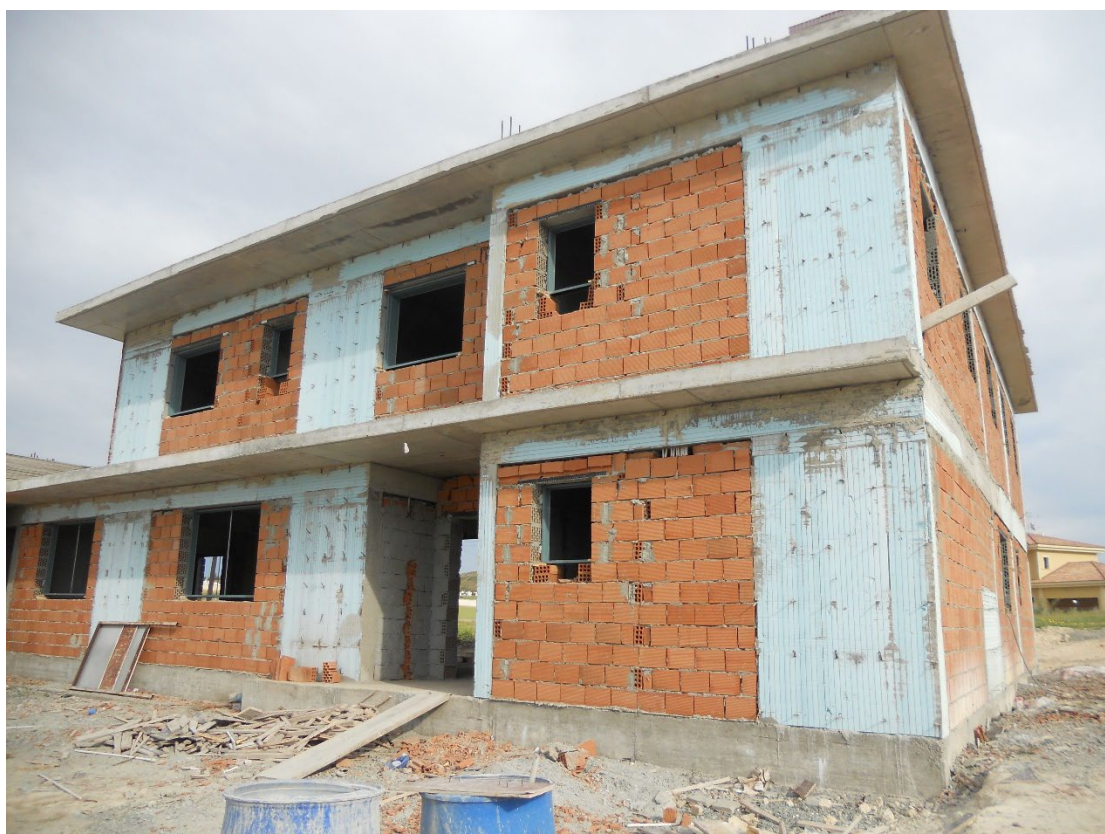
Εικόνα 2.22: Κατοικία με φέροντα οργανισμό θερμομονωμένο με εξηλασμένη πολυστερίνη και τοίχους πλήρωσης από θερμομονωτικά τούβλα, έτοιμη να δεχθεί εξωτερικά επίχρισματα.
