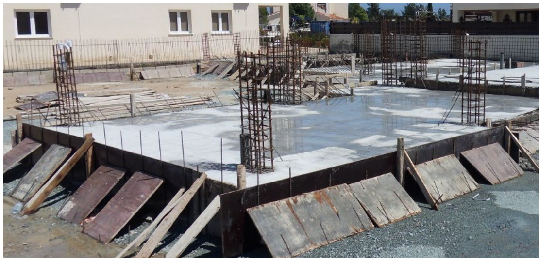
Εικόνα 4.14: Πεδιλόπλακα κατοικίας, από την οποία εξέρχει ο οπλισμός των βάσεων των κολώνων (αναμονές) ο οποίος θα δεχθεί τον οπλισμό των υποστυλωμάτων.
