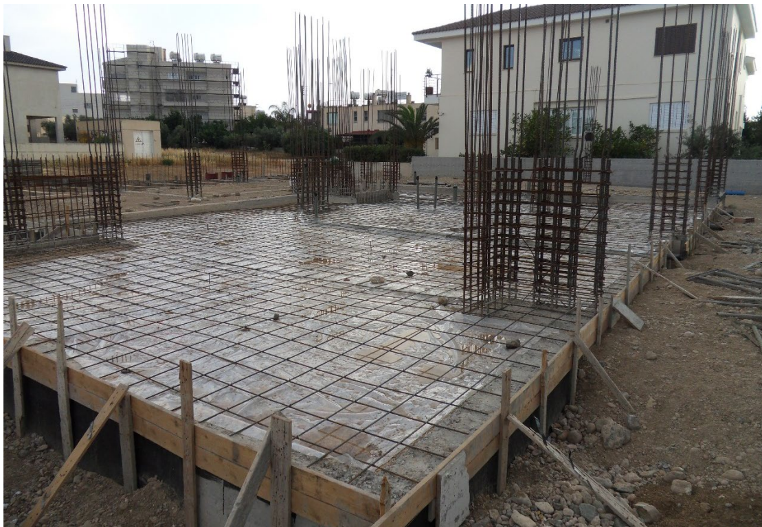
Εικόνα 4.7: Προετοιμασία σκυροδέτησης πατώματος ισογείου με τοποθέτηση φύλλου πολυθίνης και μεταλλικής σχάρας επί της επιχωμάτωσης των φερόντων στοιχείων της θεμελίωσης.
