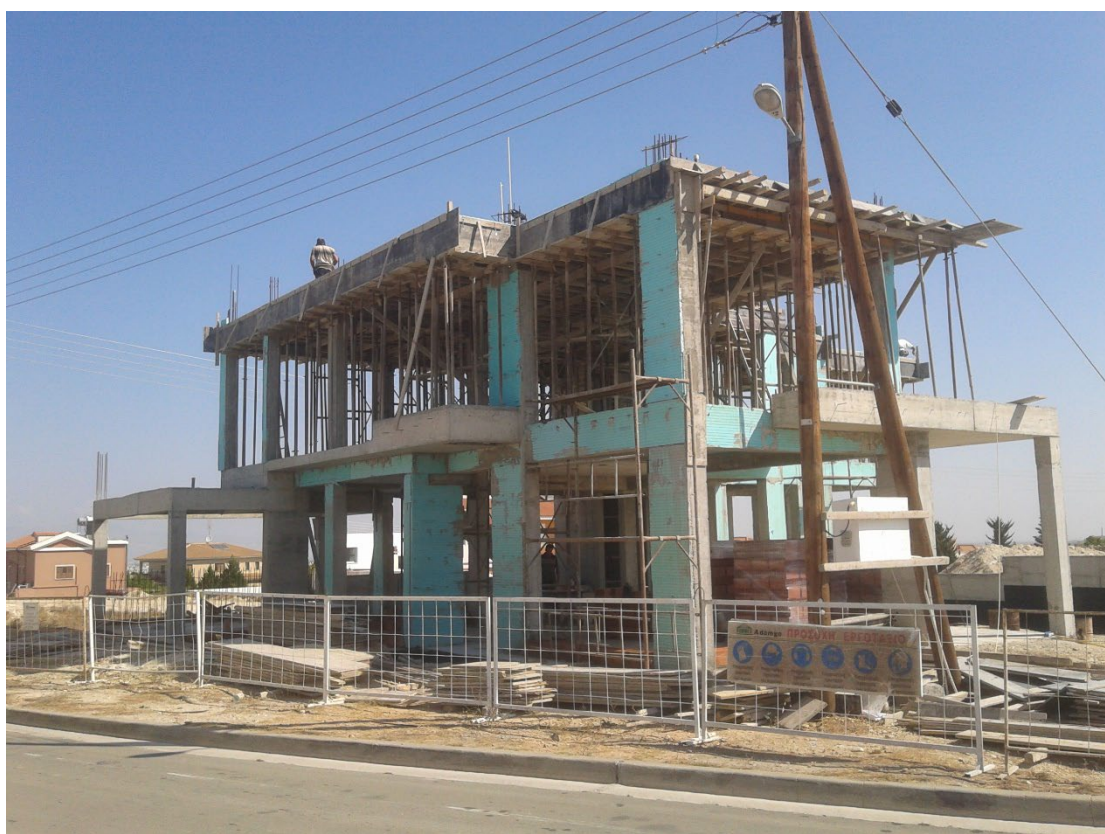
Εικόνα 4.1: Υπό ανέγερση κατοικία στη Λευκωσία που μόλις έχει ολοκληρωθεί ο φέροντας οργανισμός της, ο οποίος είναι κατασκευασμένος εξ' ολοκλήρου από οπλισμένο σκυρόδεμα.
