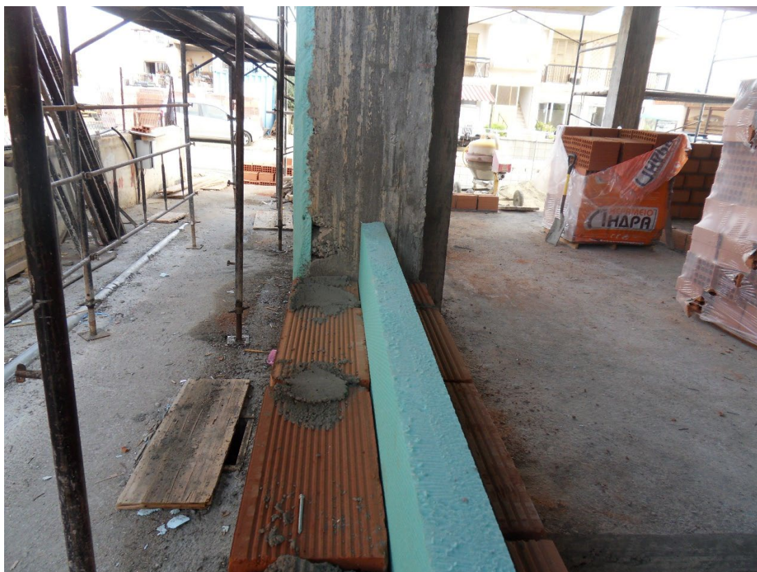
Εικόνα 2.21: Διπλός τοίχος με θερμομόνωση στη μέση, όπου ο εξωτερικός τοίχος είναι κτισμένος με τούβλα πάχους 15 εκατοστών έτσι ώστε τα 2/3 να έρχονται σε επαφή με τα φέρονται στοιχεία.
