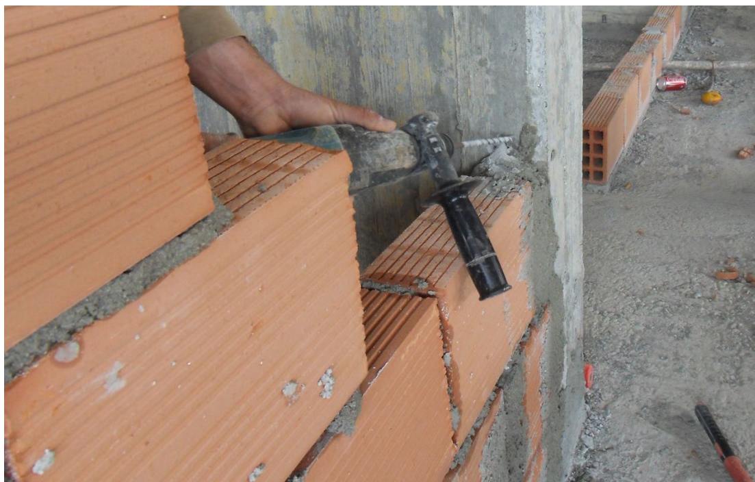
Εικόνα 2.2: Άνοιγμα οπής με αρίδα σε υποστύλωμα για εμφύτευση σιδήρου με σκοπό την σύνδεση της τοιχοποιίας με το φέρον στοιχείο.
