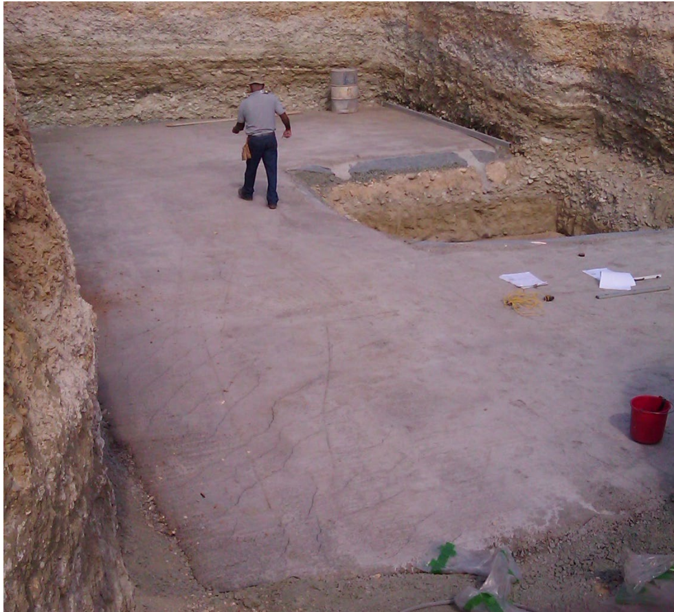
Εικόνα 4.12: Διάστρωση άοπλου σκυροδέματος καθαριότητας (γκρο μπετόν) για τη δημιουργία καθαρής επιφάνειας για να μπορέσουν να ξεκινήσουν οι εργασίες σιδήρου της πεδιλόπλακας.
