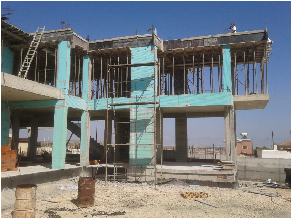
Εικόνα 2.13: Κατοικία με φέροντα οργανισμό από οπλισμένο σκυρόδεμα, ο οποίος έχει θερμομονωθεί εξωτερικά με επικολλημένες πλάκες εξηλασμένης πολυστερίνης.
