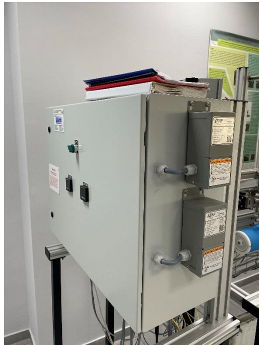
Εικόνα 21: Μονάδα ελέγχου ισχύος στο sizing line
