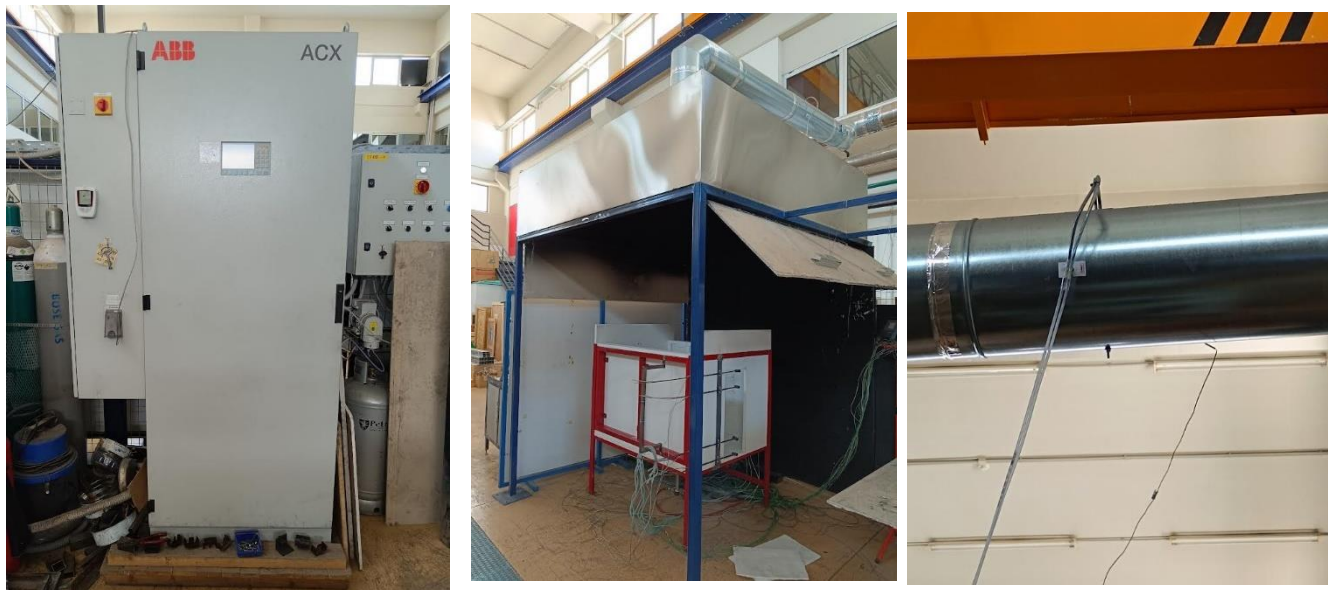
Εικόνα 5.9 Αναλυτής καυσαερίων (αριστερά), απαγωγός καυσαερίων (κέντρο), ακροφύσιο τοποθετημένο στο σωλήνα απαγωγής (δεξιά).
