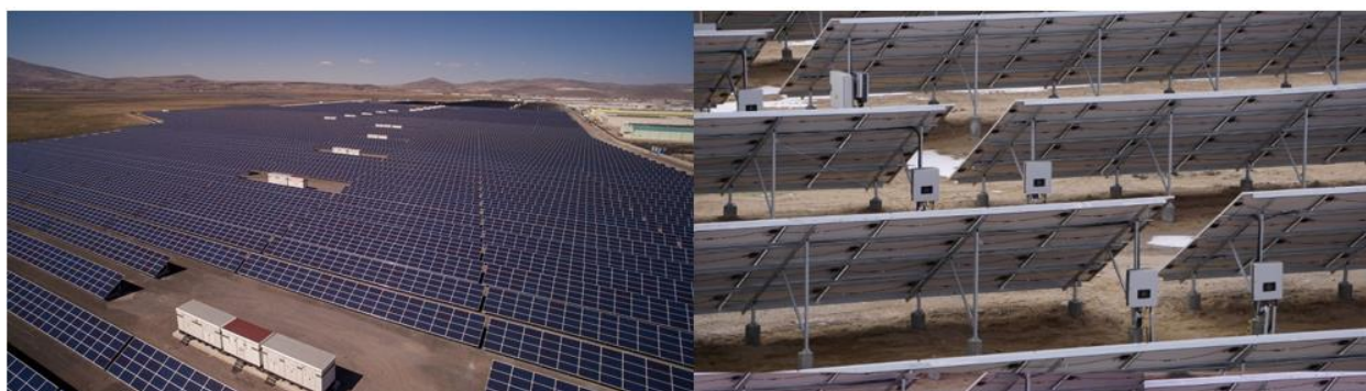
Εικόνα 17 Φωτοβολταϊκός Σταθμός με Κεντρικούς Αντιστροφέις (Αριστερά) και Αντιστροφέις Σειράς (Δεξιά) (Lusson, 2024)
