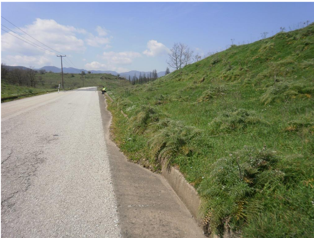
Εικόνα 2.1 Μετακίνηση πρηνούς αργιλώδους εδάφους προς το οδικό δίκτυο
