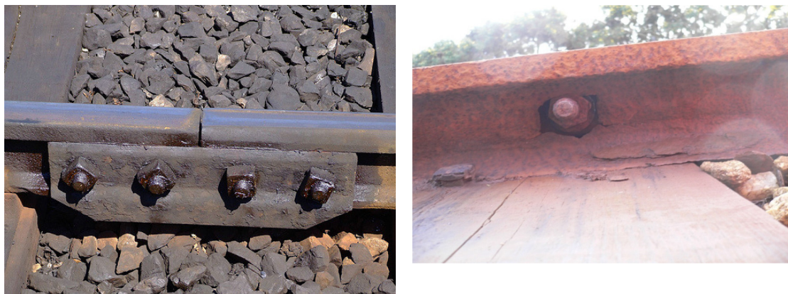
Εικόνα 4.8 Οι βιδωτοί αρμοί αστοχούν λόγω κόπωσης και διάβρωσης. (Πηγή: Διαδίκτυο)
