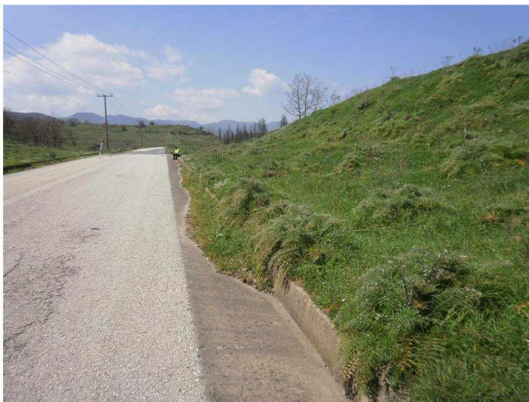
Εικόνα 2.7 Μετακίνηση πρηνούς αργιλώδους εδάφους προς το οδικό δίκτυο
