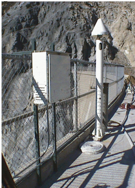
Εικόνα 2.13 Η κεραία του δέκτη GPS στο εσωτερικό του χαλύβδινου πυλώνα
