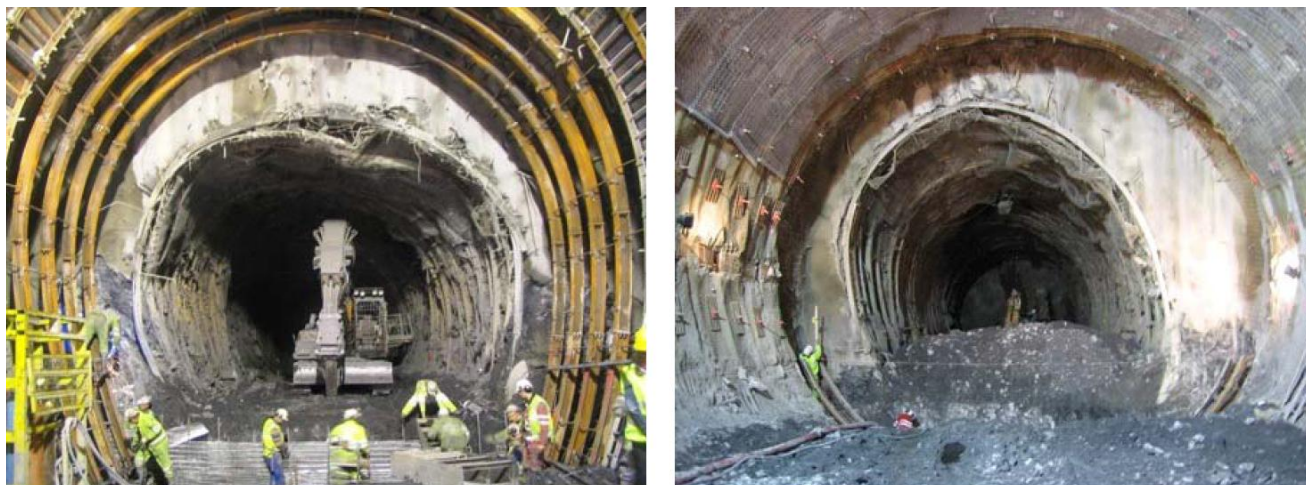
Εικόνα 7.2: Παραμορφωμένη διατομή λόγω εκτεταμένων συγκλίσεων στη σήραγγα βάσης Lyon-Turin (Barla et al., 2010).
