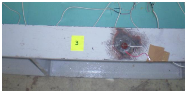
Σχήμα 4-6 Μπροστά κάτω δοκός μεταλλικού πλαισίου, Θ3
