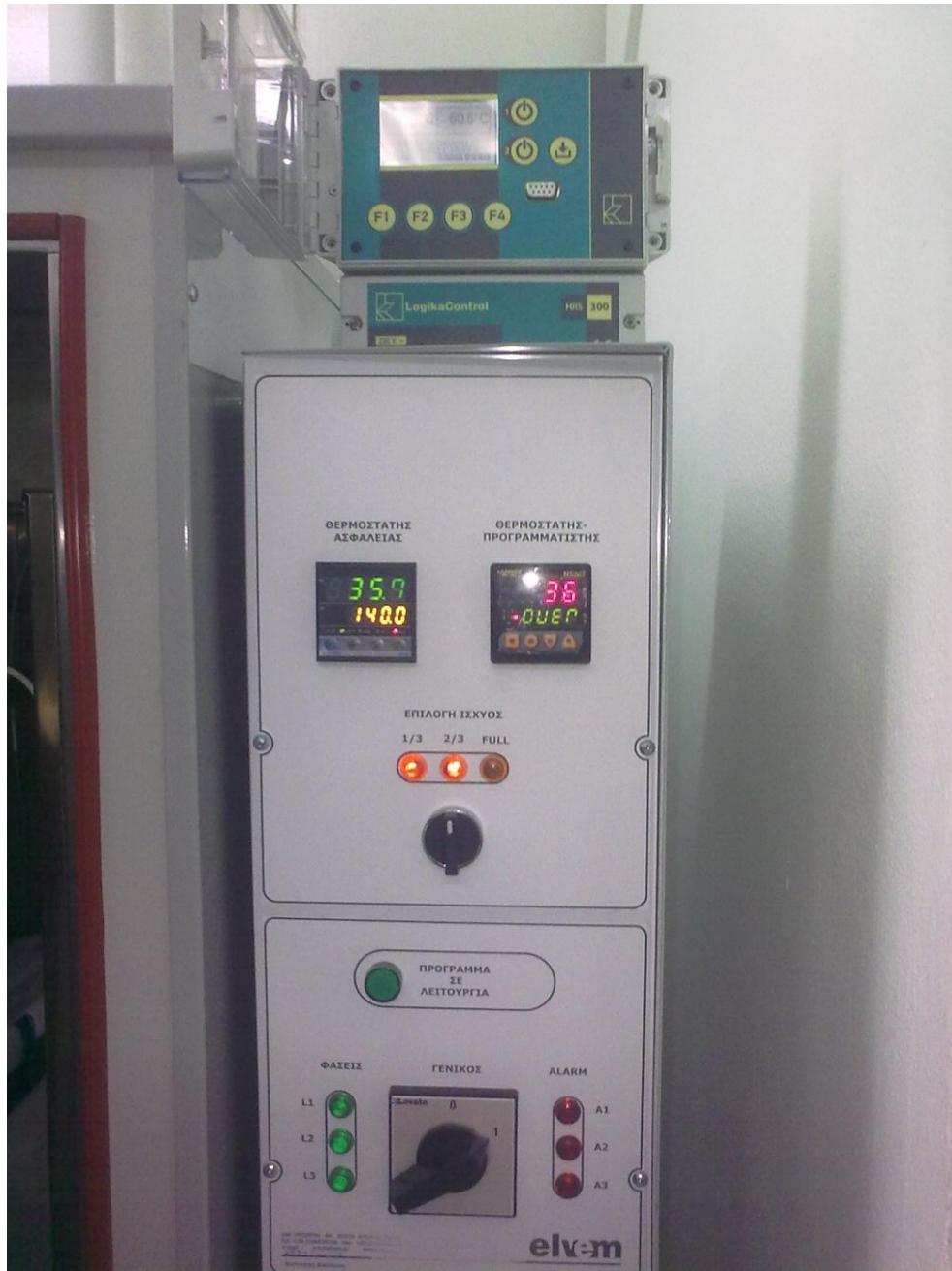
Εικόνα 2.1.2-4 Κέντρο ελέγχου φούρνου και μετρητικά όργανα.
